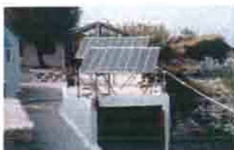
Σχήμα 2.2.20: Αυτόνομο σύστημα στην Κύμη Ευβοίας, που ηλεκτροδοτεί μοναστηριακό μετόχι μόνιμης διαμονής.
