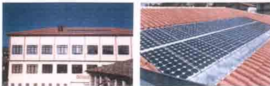
Σχήμα 2.2.28: Διασυνδεδεμένο σύστημα με ενσωματωμένες τις φωτοβολταϊκές γεννήτριες στην οροφή του κτιρίου (αντί για κεραμίδια) στο Κέντρο Περιβαλλοντικής Εκπαίδευσης (ΚΠΕ) Καστοριάς. Πρωτοποριακή εφαρμογή για τον ελλαδικό χώρο διότι οι φωτοβολταϊκές γεννήτριες είναι ενσωματωμένες στην οροφή του κτιρίου ως δομικά υλικά (αντί για κεραμίδια), συμβάλλοντας έτσι εκτός από την εξοικονόμηση ενέργειας, στη μείωση κόστους των δομικών υλικών, αλλά και στην αισθητική του κτιρίου. Παρόμοια εγκατάσταση έχει πραγματοποιηθεί από τη ΣΕΝΕΡΣ και στο 3ο Δημοτικό Σχολείο Σχηματρίου.
