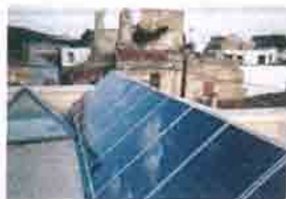
Σχήμα 2.2.33: Υβριδικό σύστημα σε συνδυασμό με το κεντρικό δίκτυο σε εργαστήριο στον Μαρουλά Ρεθύμνου.
