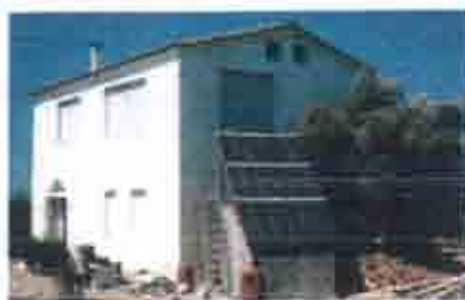
Σχήμα 2.2.19: Αυτόνομο σύστημα σε κατοικία μόνιμης διαμονής στο Ρέθυμνο Κρήτης.
