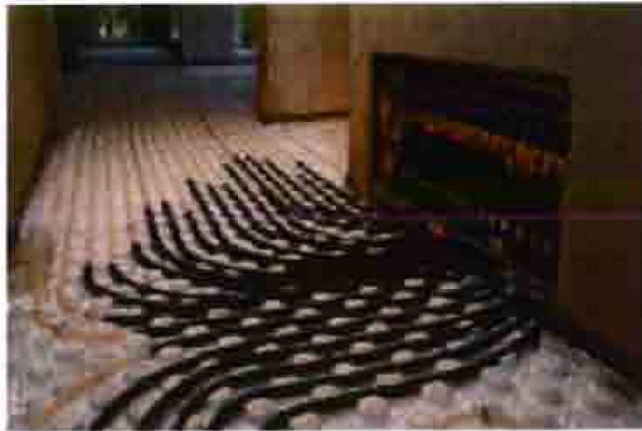
Εικόνα 25 : Παρουσίαση συλλέκτη και η σύνδεση του με της σωλήνωσης του ενδοδαπέδιου συστήματος
