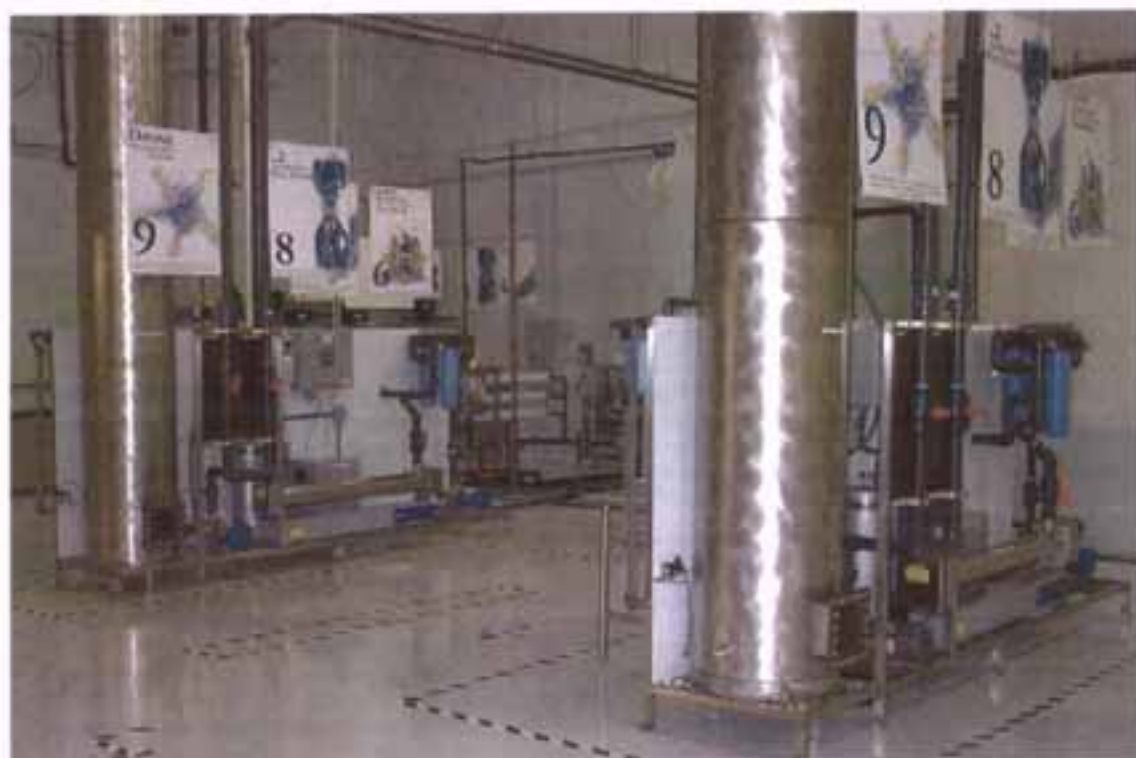
Σχ 6.2.3.7 Εγκατάσταση βιομηχανικής επεξεργασίας νερού
