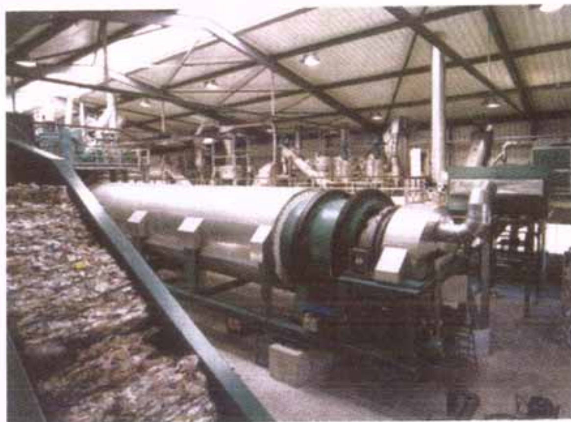
Σχ. 7.2.2.1 Εγκατάσταση μηχανικής ανακύκλωσης
