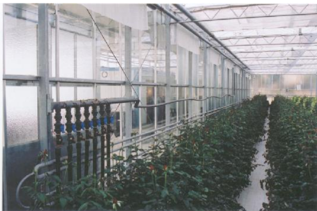
Φώτο 7: Παρατηρούμε τον αγωγό τροφοδοσίας του συστήματος άρδευσης, ο οποίος καταλήγει σε επτά σωλήνες, μέσω των οποίων τροφοδοτούνται με νερό οι σωλήνες εφαρμογής.
