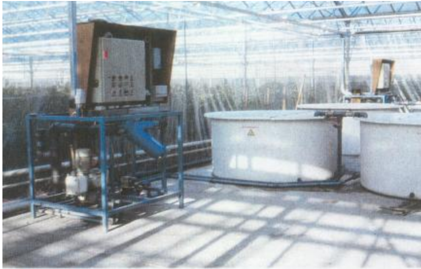
Εικ. 5.9. Αυτόματη άρδευση και υδρολίπανση που ελέγχεται από ηλεκτρονικό υπολογιστή
