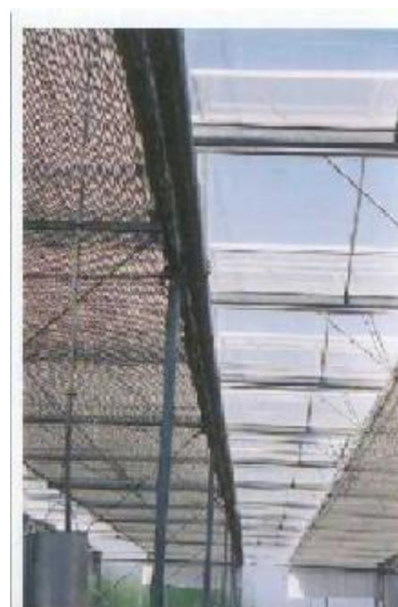
Φώτο 5: Σωλήνας θέρμανσης στην οροφή του θερμοκηπίου.
