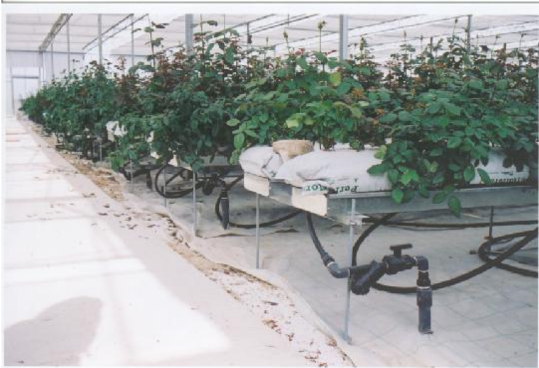
Φώτο 8: Σ' αυτή την φωτογραφία φαίνονται οι αγωγοί εφαρμογής μέσω των οποίων γίνεται το πότισμα των φυτών, καθώς επίσης και οι επιδαπέδιοι σωλήνες θέρμανσης.
