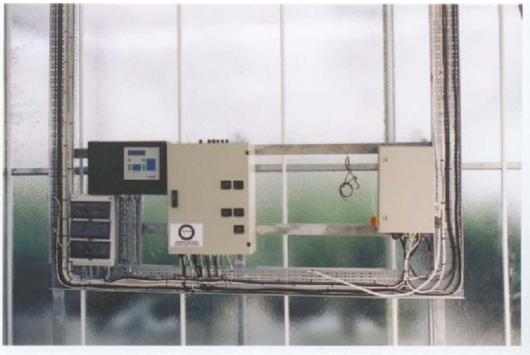
Φώτο 13: Σύστημα ελέγχου των κλιματολογικών συνθηκών του θερμοκηπίου.
