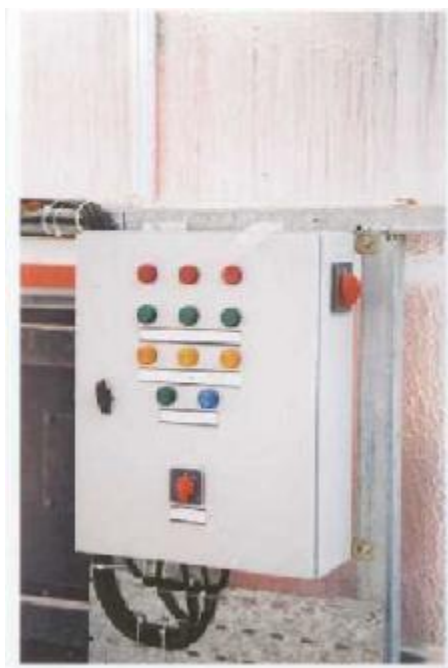
Φώτο 4: Σύστημα λειτουργίας του λέβητα.
