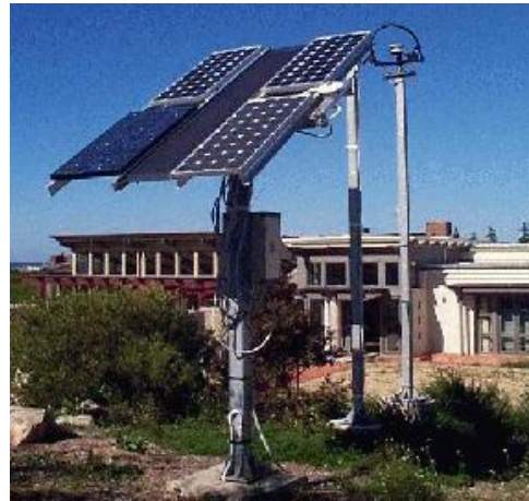
Σχήμα Δ: Φ/β γεννήτρια εγκατεστημένη σε σύστημα μέτρησης μετεωρολογικών μεγεθών.
