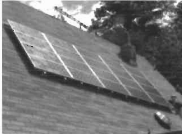
ΣΧΗΜΑ 75 Αυτή είναι η κλασική εγκατάσταση των συλλεκτών στη σκεπή της κατοικίας
