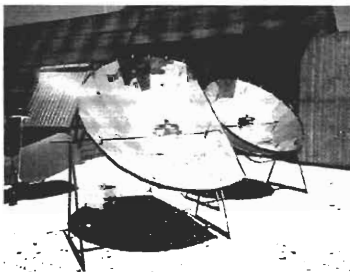
Σχήμα 1.5.6: Συγκεντρωτικός φακός ανακλαστικός παραβολικού τύπου εγκατεστημένος στο Πανεπιστήμιο Εφαρμοσμένων Επιστημών του Aachen.
