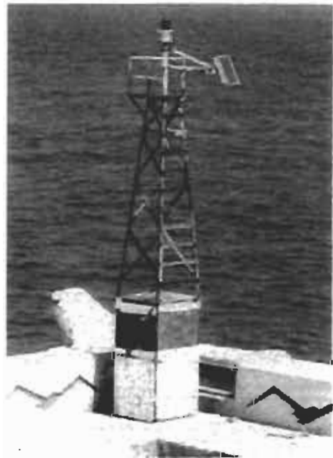
Σχήμα 1.3.1: Φάρος με φωτοβολταϊκά πλαίσια εγκατεστημένος από την Υ.Φ.Π.Ν. στην Ικαρία.
