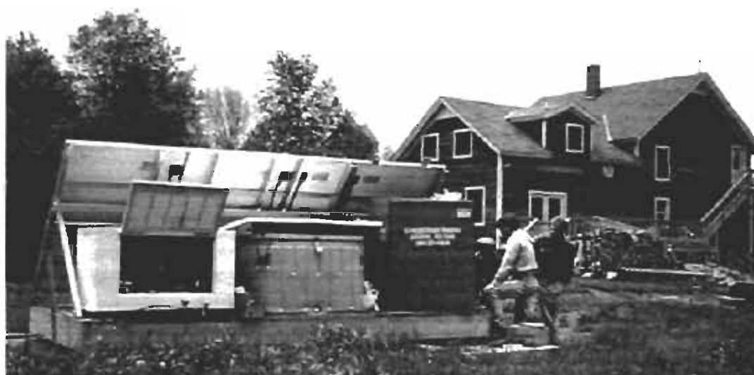
Σχήμα 4.1.11 (α) και (β): Εμπρόσθια και οπίσθια όψη ενός υβριδικού συστήματος εγκατεστημένο στο Crown Point της Νέας Υόρκης. Το σύστημα αποτελείται από φωτοβολταϊκά πλαίσια εκτάσεως 8.95\text{m}^2 και ισχύος 1\text{kWp} και μια γεννήτρια προπανίου που μπορεί να παράγει ισχύ 3.6\text{kW} .
