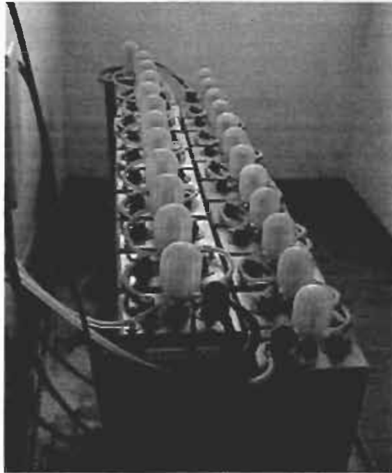
Σχήμα 4.2.1: Συσσωρευτές που χρησιμοποιούνται για την αποθήκευση ενέργειας που παράγεται από PV-πλαίσια. Εργαστήριο Η.Μ.Ε. Τ.Ε.Ι. Πάτρας. Χωρητικότητα 600Ah. Οι συσσωρευτές είναι τύπου ρέοντος ηλεκτρολύτη.
