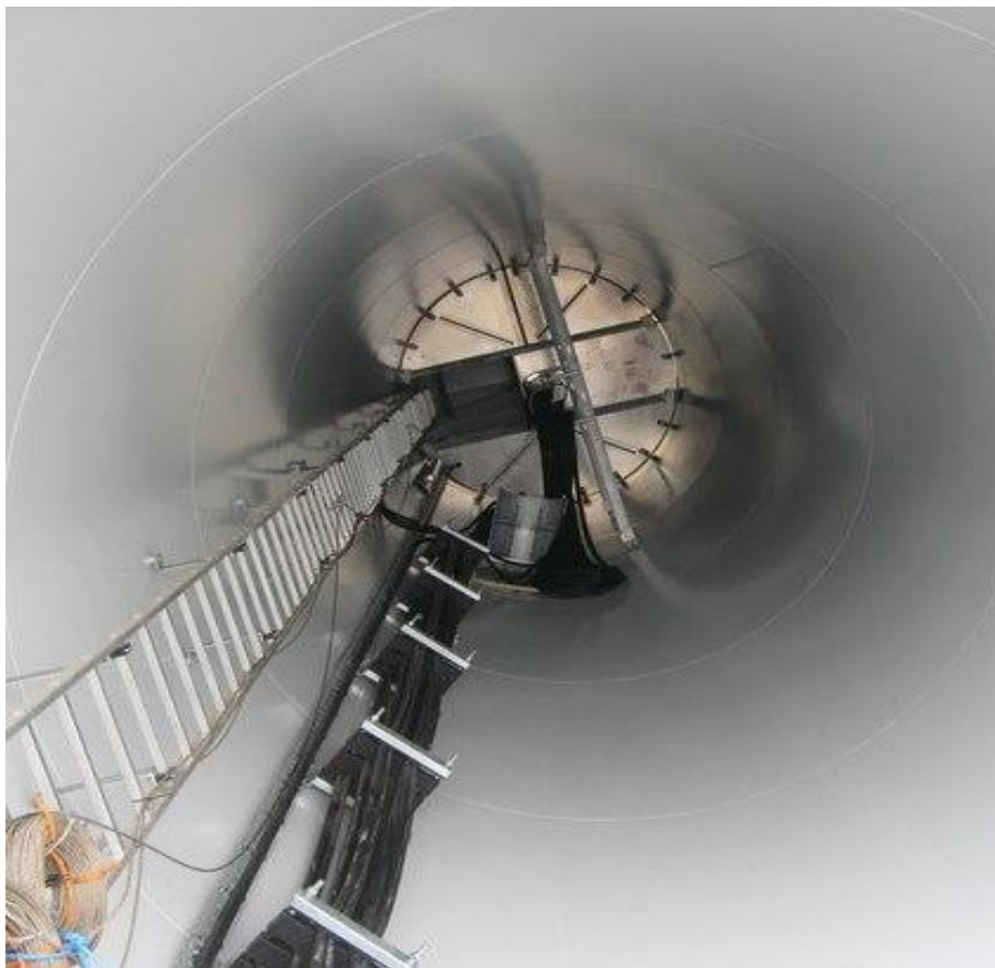
Εικόνα 2.7 : Εσωτερικό πύργου ανεμογεννήτριας. [16]
