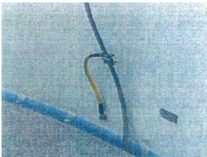
Εικόνα 5.30: Σύνδεση μεταξύ του τσιμεντένιου πύργου και του θεμελιακού ηλεκτροδίου γείωσης [16]
