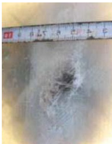
Εικόνα 5.20: Πληγείσα περιοχή πτερυγίου [17]
