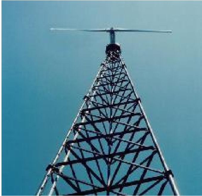
Εικόνα 2.9 : Πύργος δικτυωτού πλέγματος. [18]
