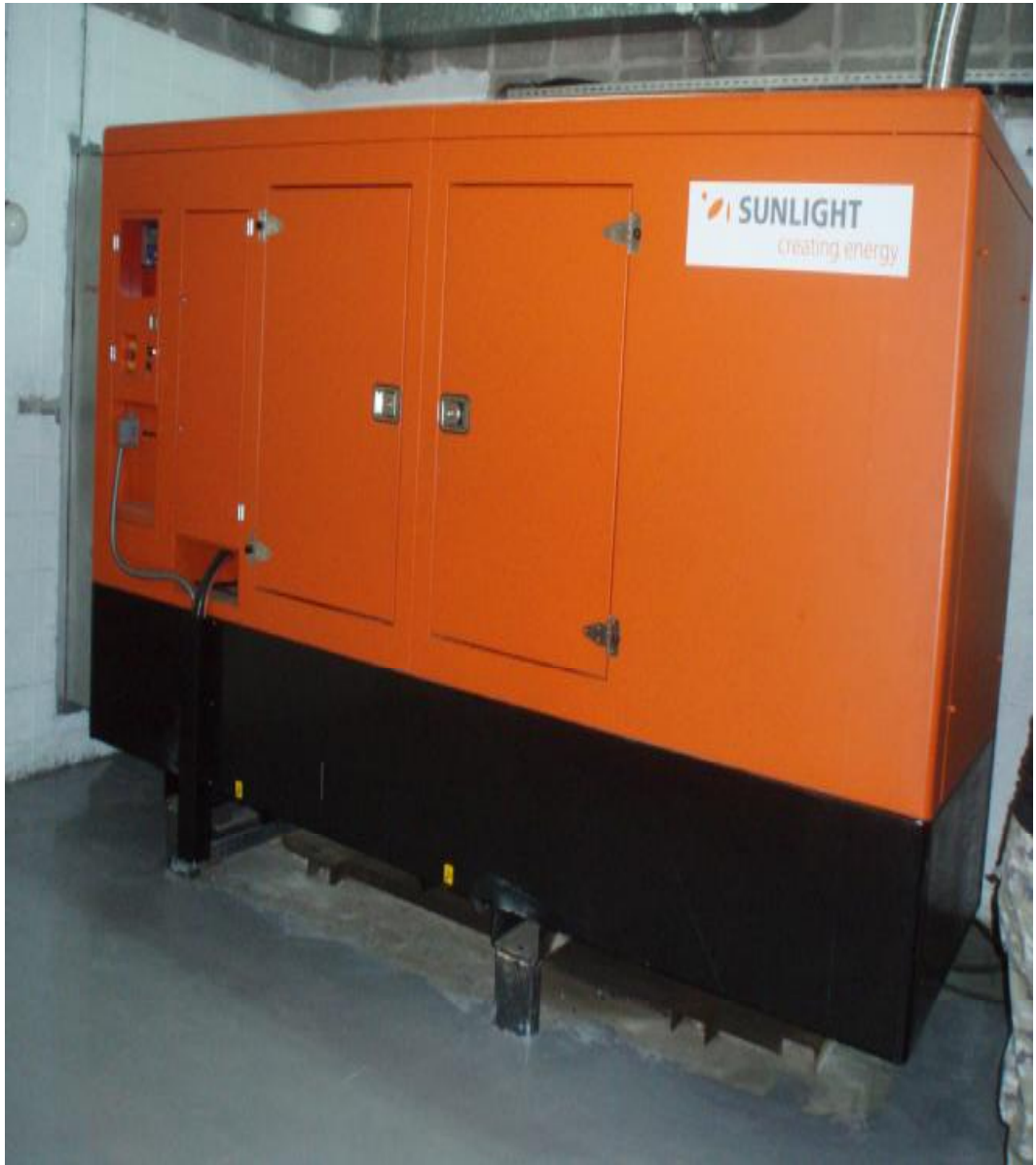
ΜΙΖΑ ΓΕΝΝΗΤΡΙΩΝ 200KVA (εικόνα 14)
