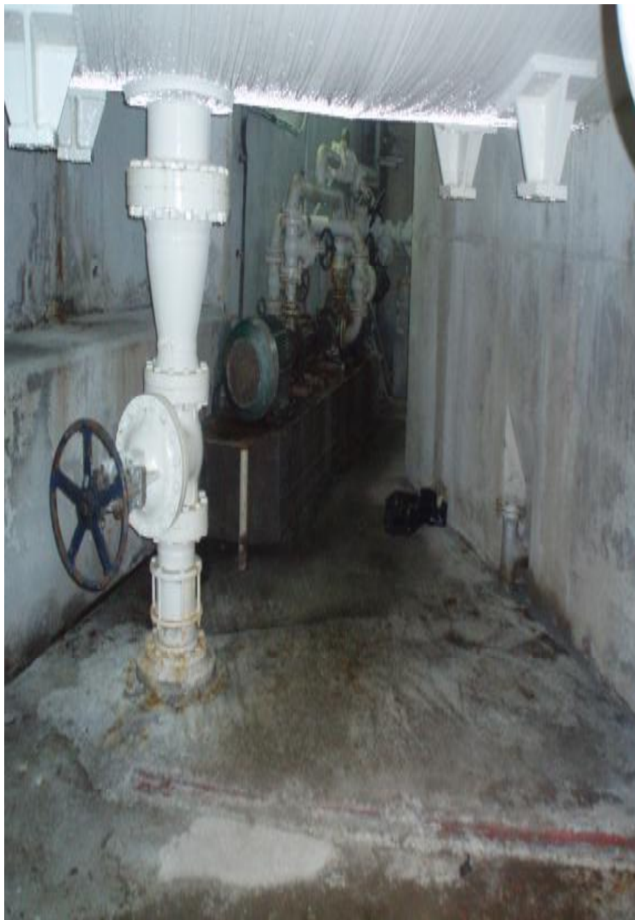
Παροχή νερού του οικισμού (εικόνα 4)
