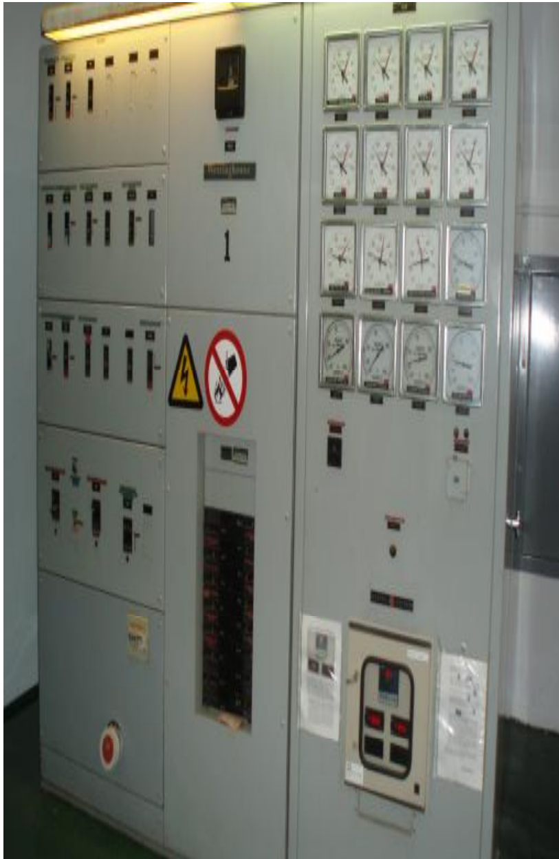
ΠΙΝΑΚΕΣ ΕΛΕΓΧΟΥ ΚΑΙ ΣΥΝΗΜΙΤΟΝΟΜΕΤΡΑ (εικόνα 7)
