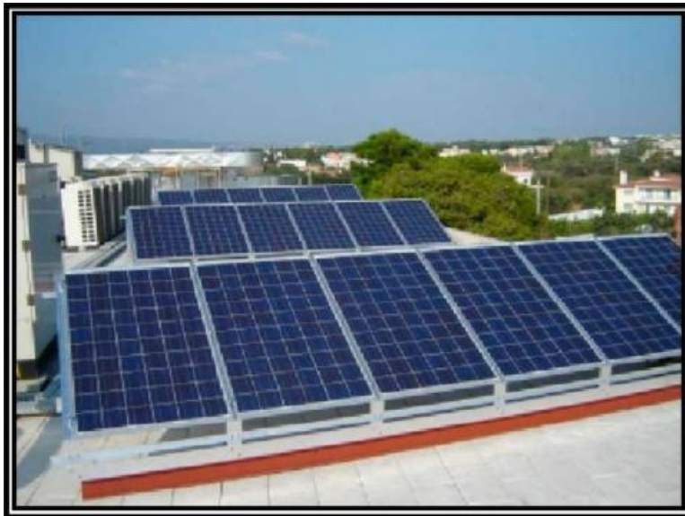
Φωτοβολταϊκά πλαίσια σε κτίριο σε κεκλιμένο επίπεδο
