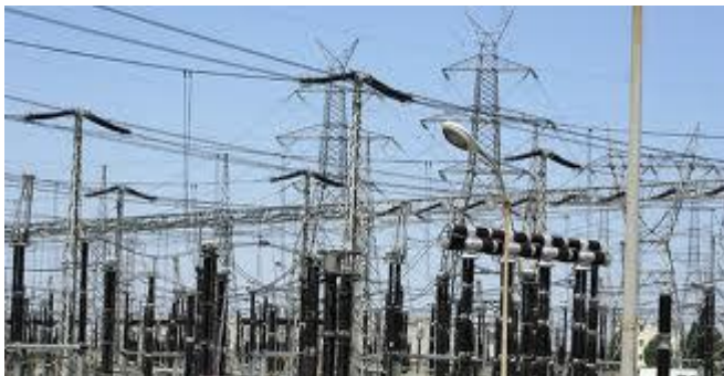
Υποσταθμός ΔΕΗ 150KV
