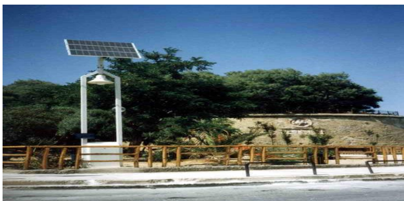
Χρήση Φ/Β σε φωτιστικό δρόμου
