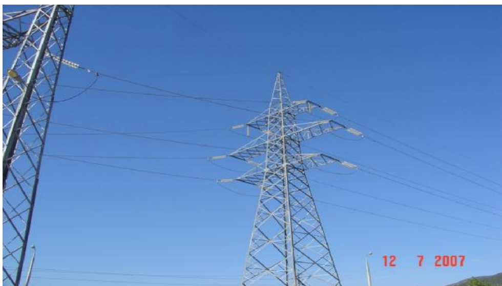
Σχήμα 1. ΓΡ.Υ.Τ. 2πλού κυκλώματος. Στην κορυφή του πυλώνα ο αγωγός Γης.
