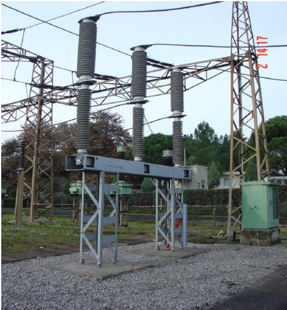
Σχήμα 35. ΑΕ/Δ 150KV με μέσον σβέσης τόξου \text{SF}_6 και χειριστήριο μηχανικό (ελατήρια), και μονωτήρες συνθετικούς.
