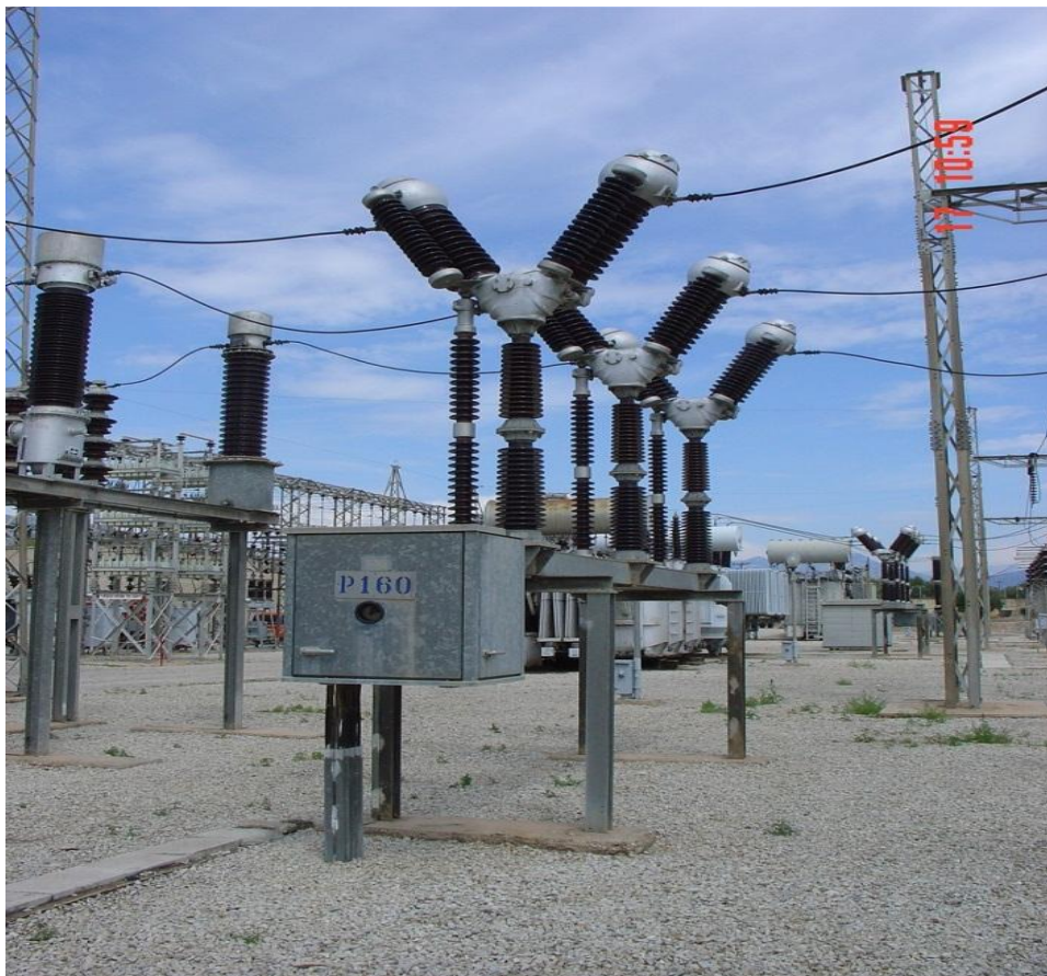
Σχήμα 30. Διακόπτης Ισχύος ελαίου 150KV, με δυο θαλάμους διακοπής τόξου.
