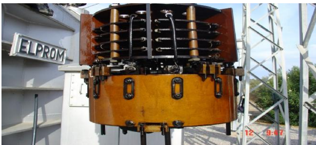
Σχήμα 24. Μεταγωγικός Διακόπτης Μ/Σ
