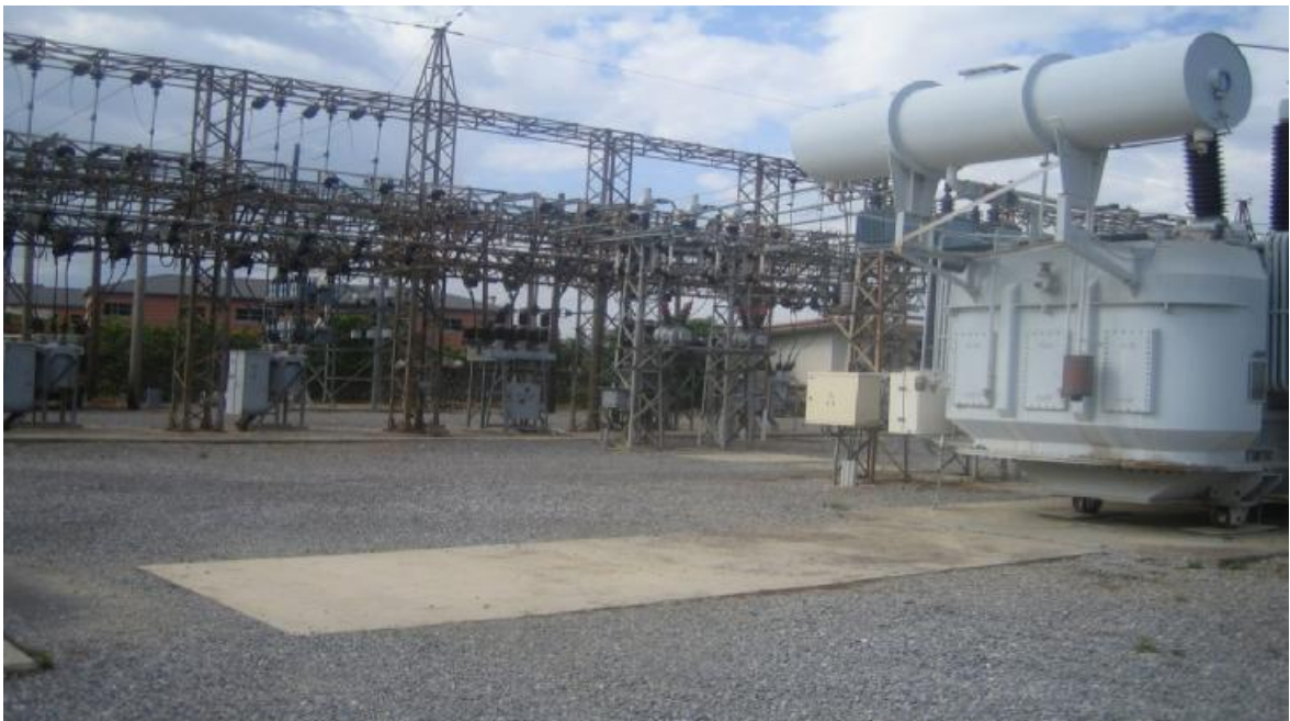
Σχήμα 16α. Δοχείο Διαστολής Μ/Σ με τον αφυγραντήρα του, στο βάθος οι Ζυγοί, Α/Ζ, και Διακόπτες της Μ.Τ.
