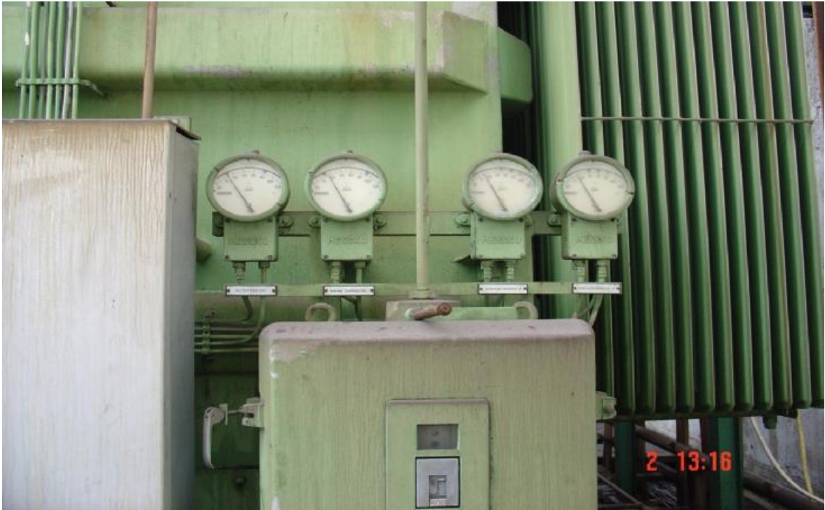
Σχήμα 25. Θερμόμετρα λαδιού και τυλιγμάτων Μ/Σ Ισχύος.
