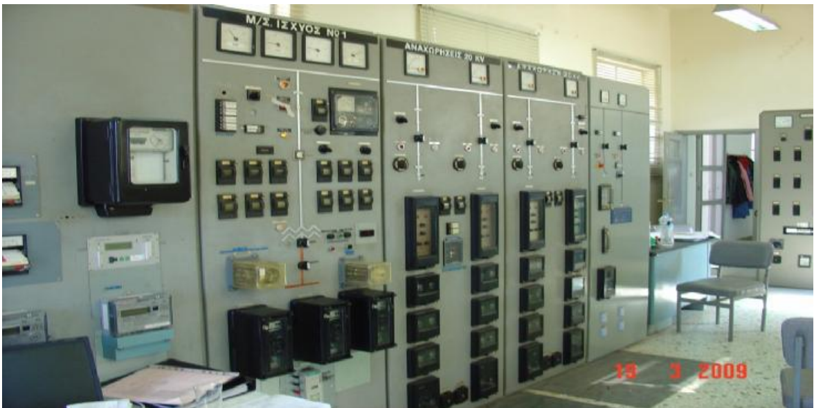
Σχήμα 7. Εξοπλισμός Υ/Σ εντός κτηρίου.
