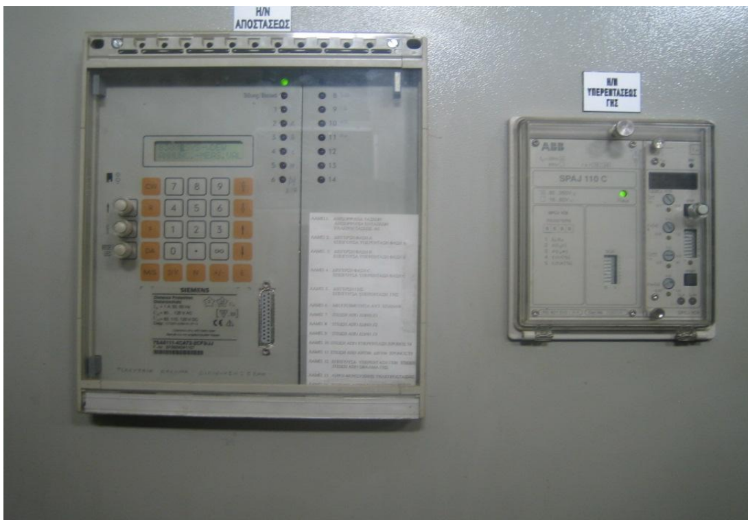
Σχήμα 56. Ψηφιακοί Η/Ν Απόστασης και δεξιά Η/Ν υπερέντασης Γης εγκατεστημένοι στον πίνακα Προστασίας εντός του κτηρίου του Υ/Σ.
