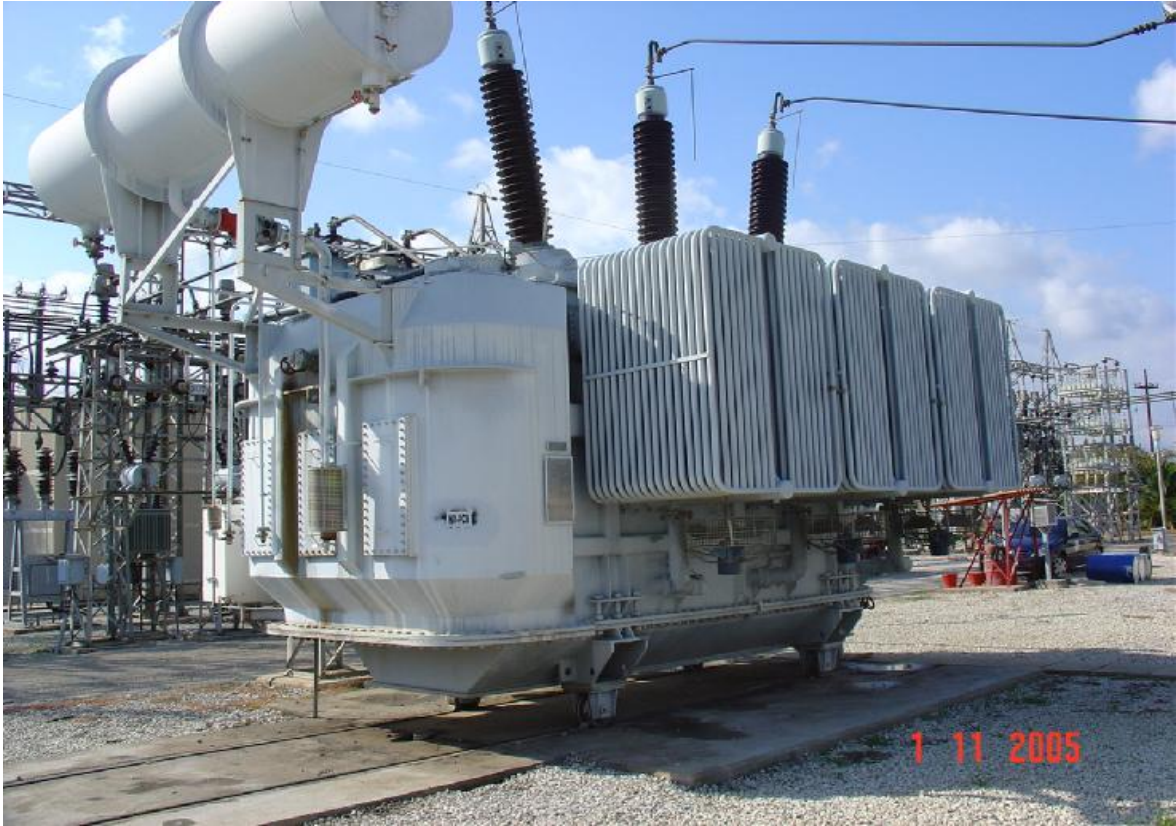
Σχήμα 15. Μ/Σ Ισχύος υποβιβασμού, τοποθετημένος στη θέση του μέσα στον Υ/Σ.
