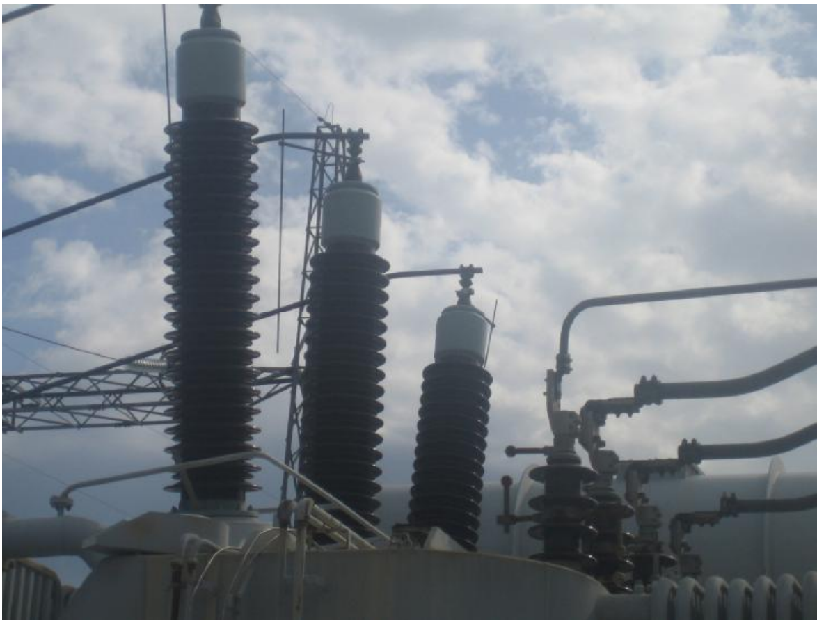
Σχήμα 20. Μονωτήρες Υ.Τ αριστερά και Μονωτήρες Χ.Τ. δεξιά σε ένα Μ/Σ Ισχύος.
