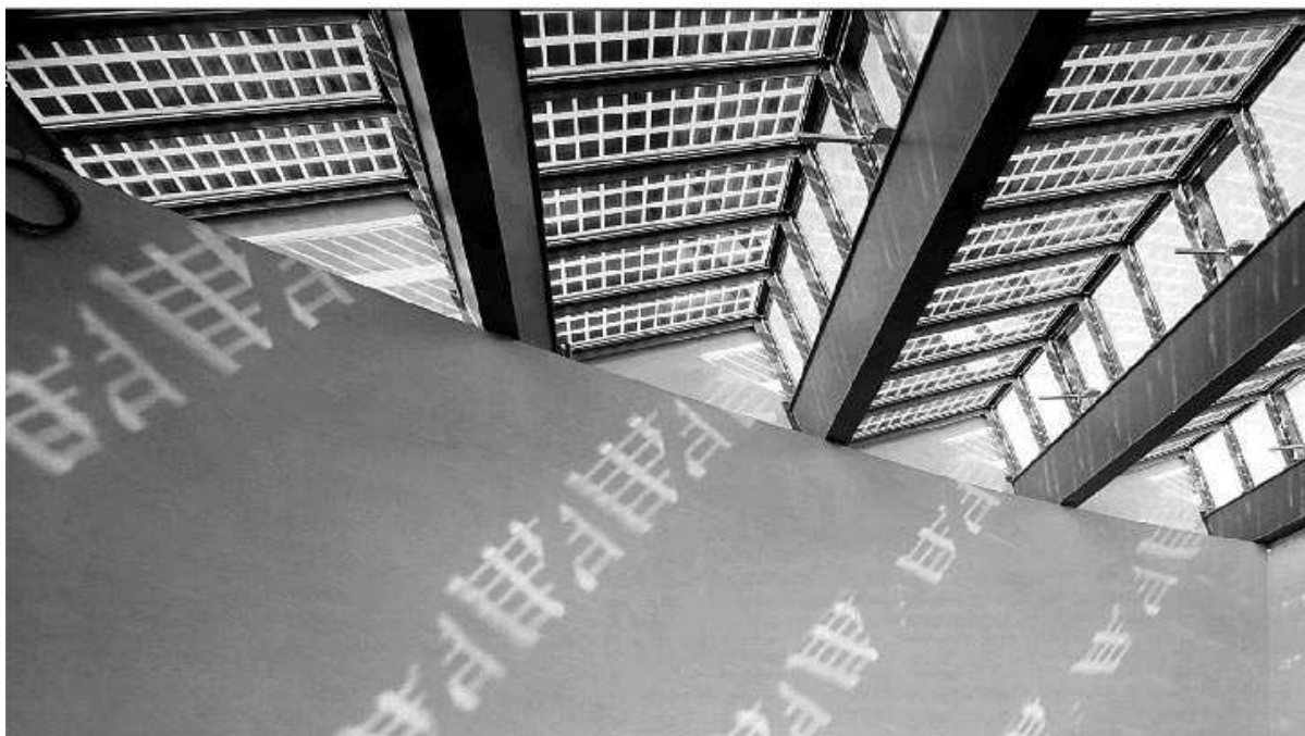
Σχήμα 2.8 Φωτοβολταϊκά σε ένα υπόστεγο στέγης. Στην περίπτωση αυτή, τα φωτοβολταϊκά κύτταρα χρησιμεύουν και ως οπτικά στοιχεία σκίασης για το χώρο κάτω, αποτρέποντας την υπερθέρμανση κάτω από το καλοκαίρι
