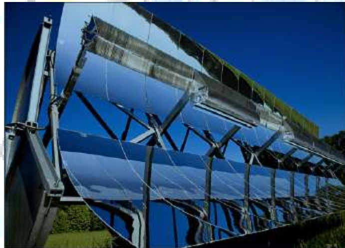
Εγκατάσταση συγκεντρωτικών ΦΒ διατάξεων
