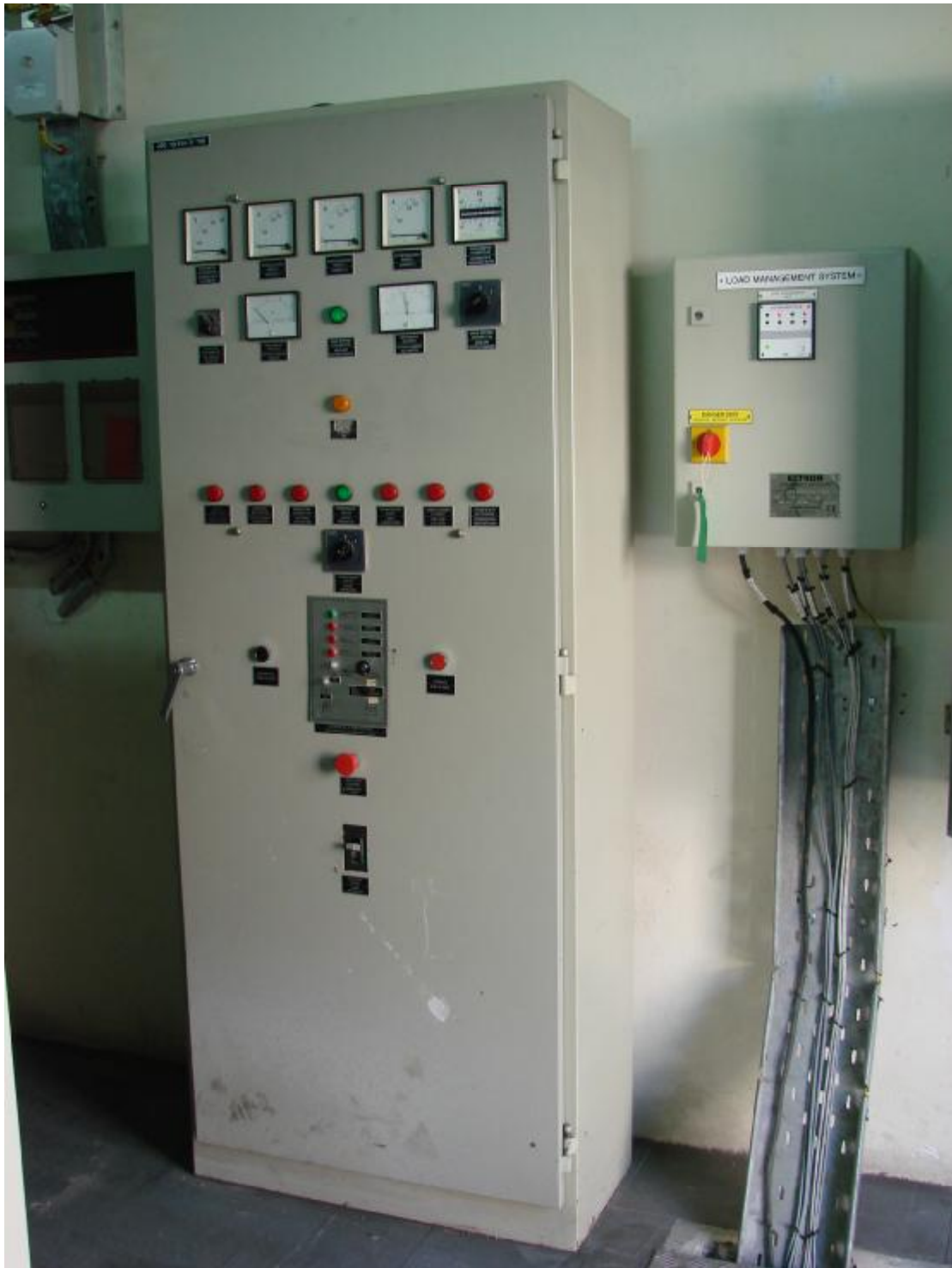
Εικόνα6.5 Πίνακας γεννήτριας εκτάκτου ανάγκης(EDG)
