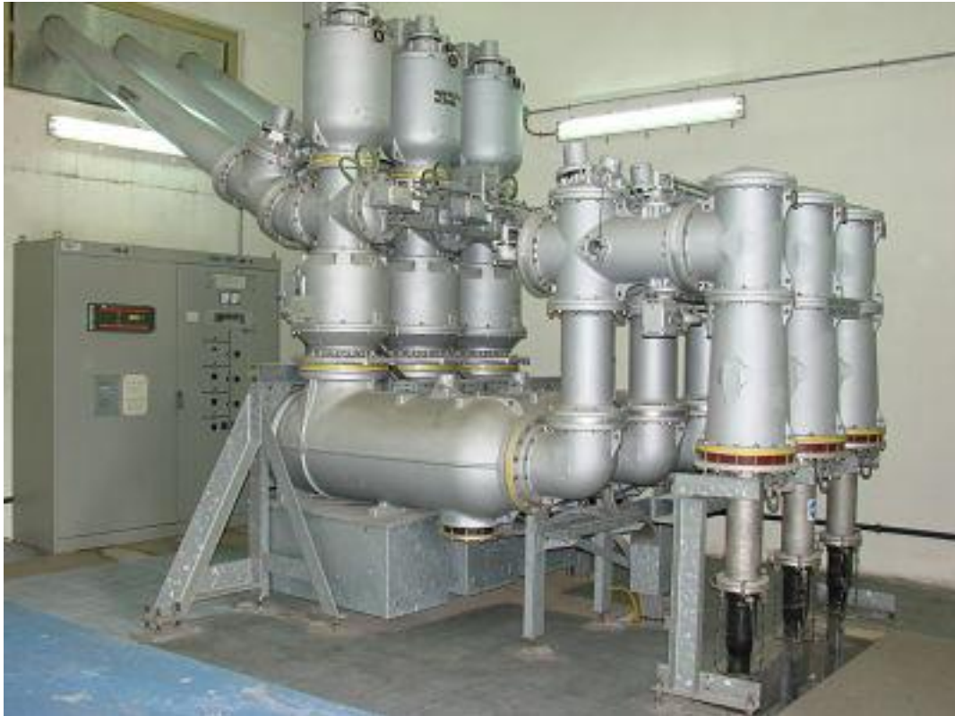
Εικόνα 3.1.4 Αυτόματοι διακόπτες 150KV
