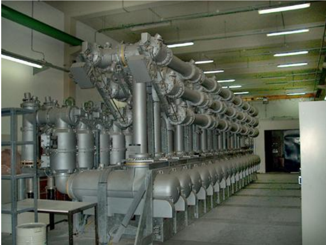
Εικόνα 3.3.1 Αυτόματος διακόπτης 150 KV των 2συστημάτων
