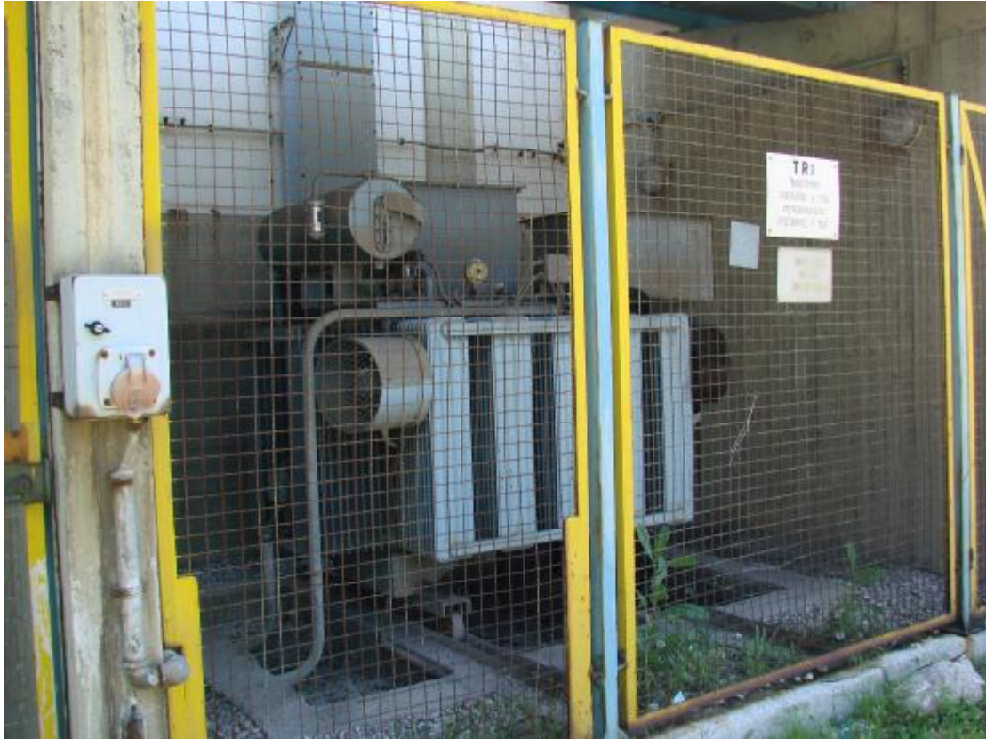
Εικόνα 6.2 Μετασχηματιστής διανομής 6kV/0,4kV
