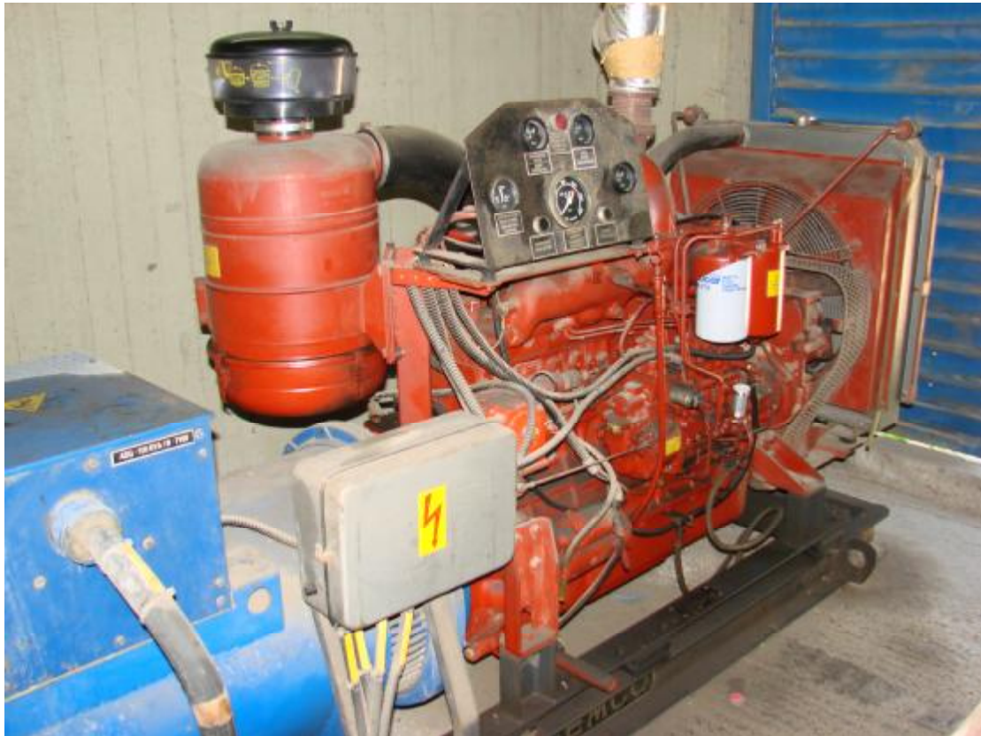
Εικόνα 6.4 Γεννήτρια Εκτάκτου Ανάγκης EDG (Emergency Diesel Generator)
