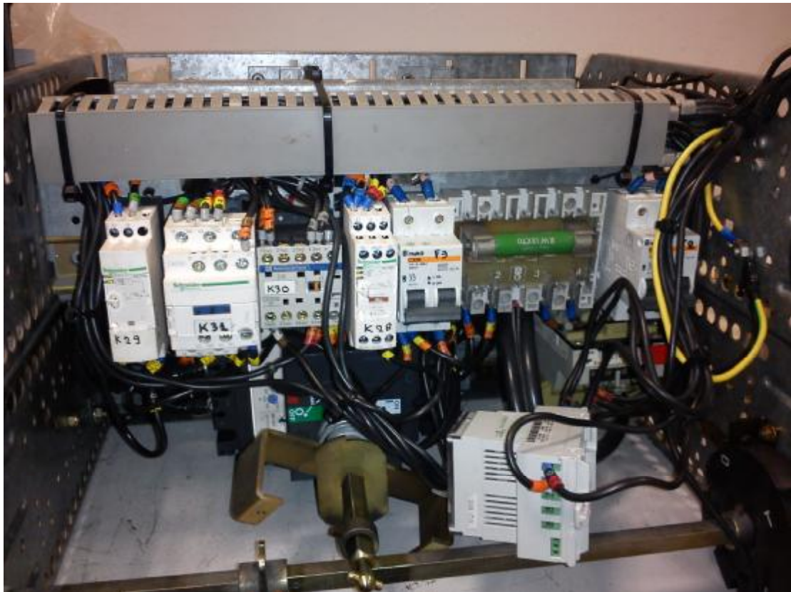
Εικόνα 10.1 Βοηθητικό κύκλωμα από συρτάρι τροφοδοσίας αντλίας
