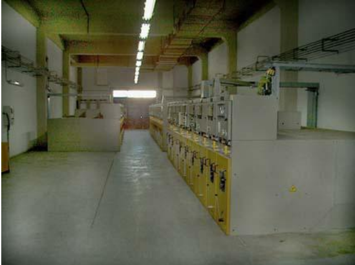
Εικόνα 3.4.1 Στην εικόνα βλέπουμε τους 3 ζυγούς τροφοδοσίας BUS A-BUS B-BUS C.
