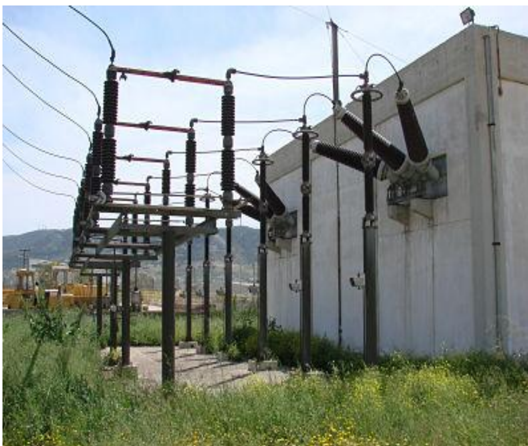
Εικόνα 3.1.1 Μονωτήρες διέλευσης μεταφοράς στους διακόπτες των 150KV
