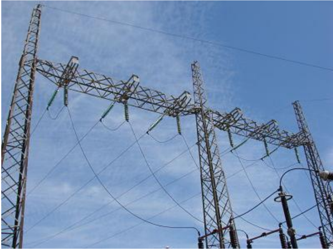
Εικόνα 3.1.3 Εναέρια μεταφορά 2 κυκλωμάτων 150 KV
