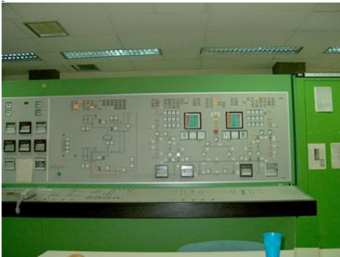
Εικόνα 7.2.3 Control Panel της γεννήτριας
