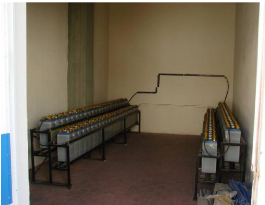
Εικόνα 8.1 Χώρος Συσσωρευτών Ni-Cd, Υποσταθμού (Battery Room)
