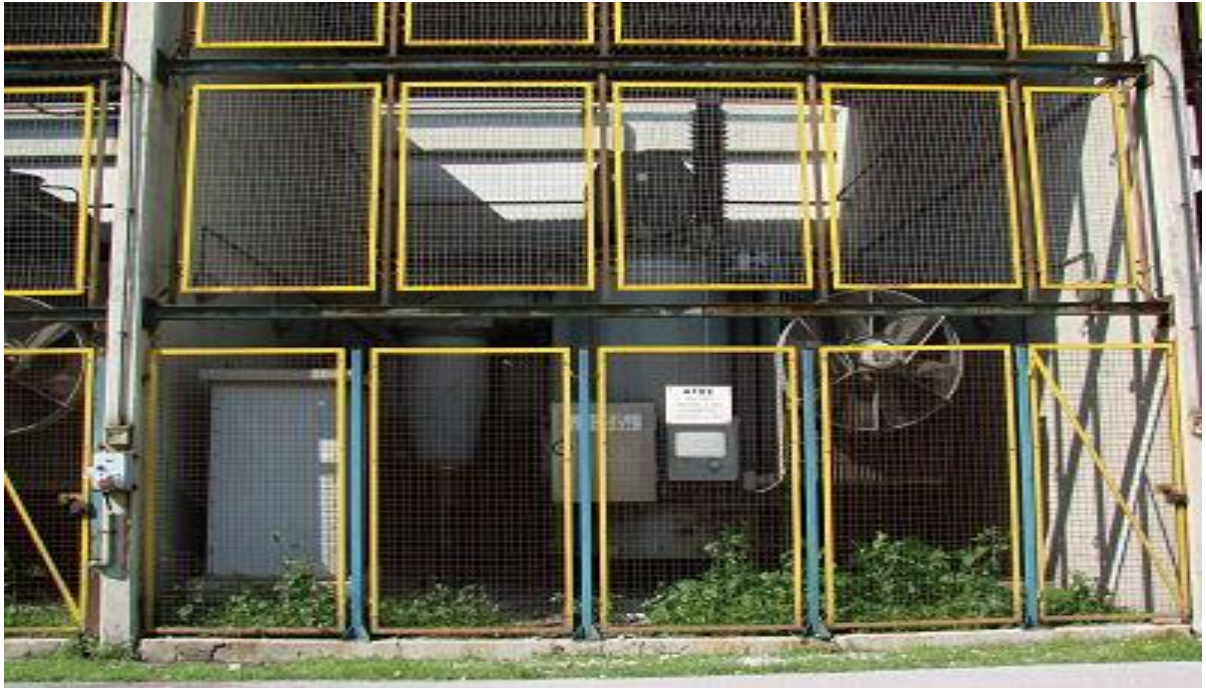
Εικόνα 2.2.2 Μετασχηματιστής 150kV/6 kV
