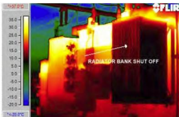
Εικόνα 20 : Μονάδα ψύξης που δεν λειτουργεί
