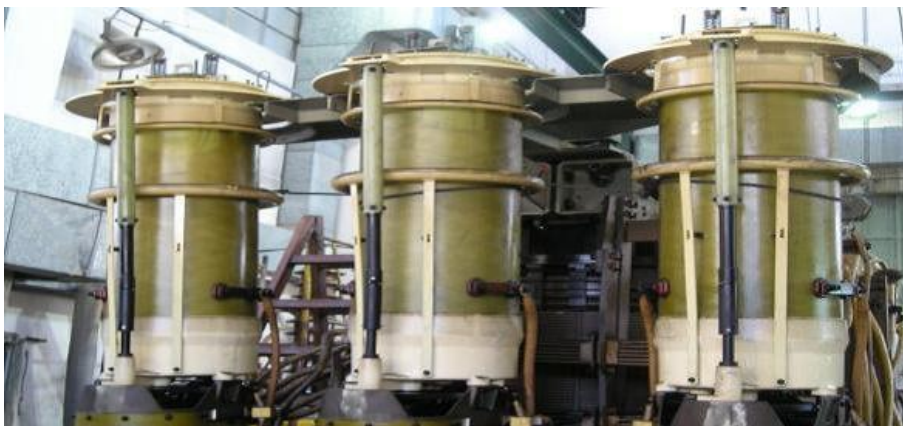
Εικόνα 28 : Μεταγωγέας λήψεων OLTC
