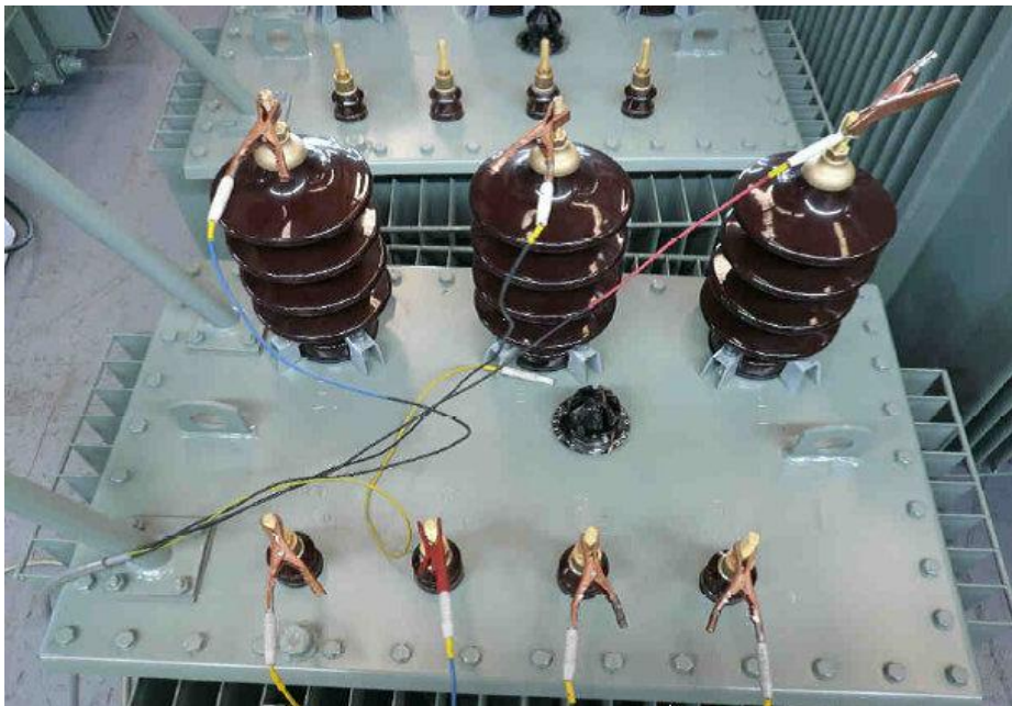
Εικόνα 14 : Συνδεσμολογία ακροδεκτών μετρητή λόγου μετασχηματισμού και ομάδας συνδεσμολογίας
