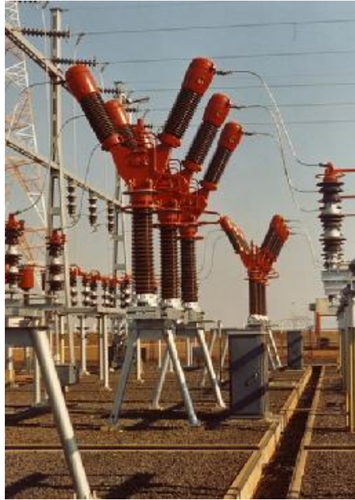
Διακόπτες ισχύος ΥΤ τύπου πτωχού ελαίου
