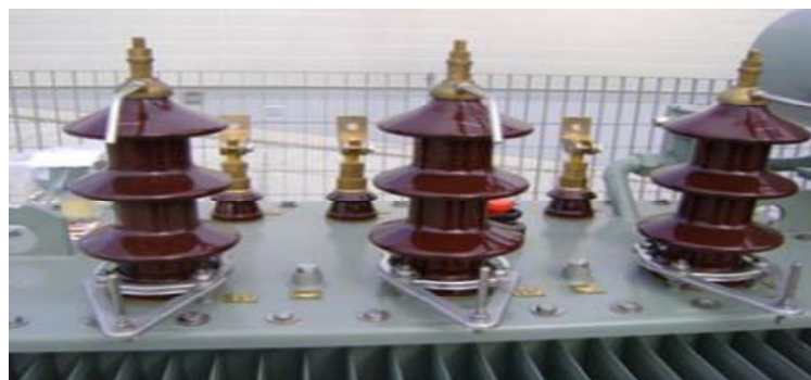
Σχ. (5.8.3): Ακροδέκτες υψηλής και χαμηλής τάσης
