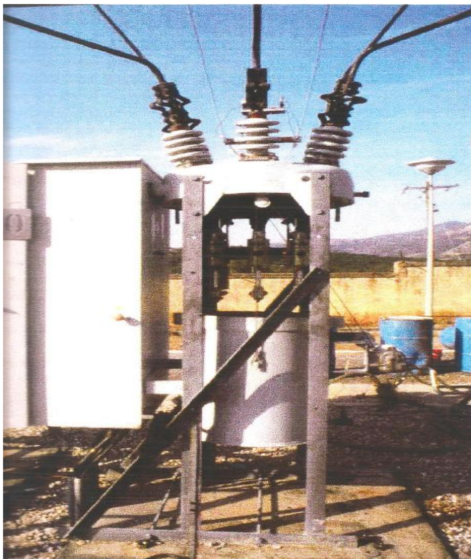
Σχ.(3.2.1): Ελαιοδιακόπτης (Ε/Δ) SIEMENS
