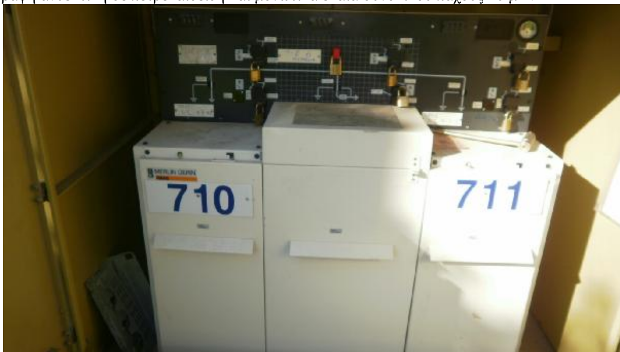
Σχ.(5.4.1): Εξωτερικό Περίβλημα Πίνακα Μ.Τ
