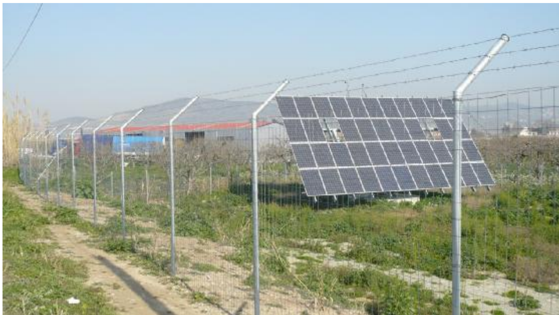
Εικόνα 27 Λήψη απο περιφραγμένο φωτοβολταϊκό πάρκο
