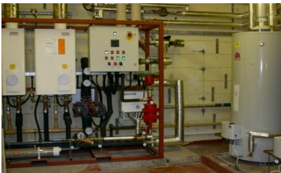
Εικόνα 6.7.: Καυστήρας - λέβητας φυσικού αερίου.
