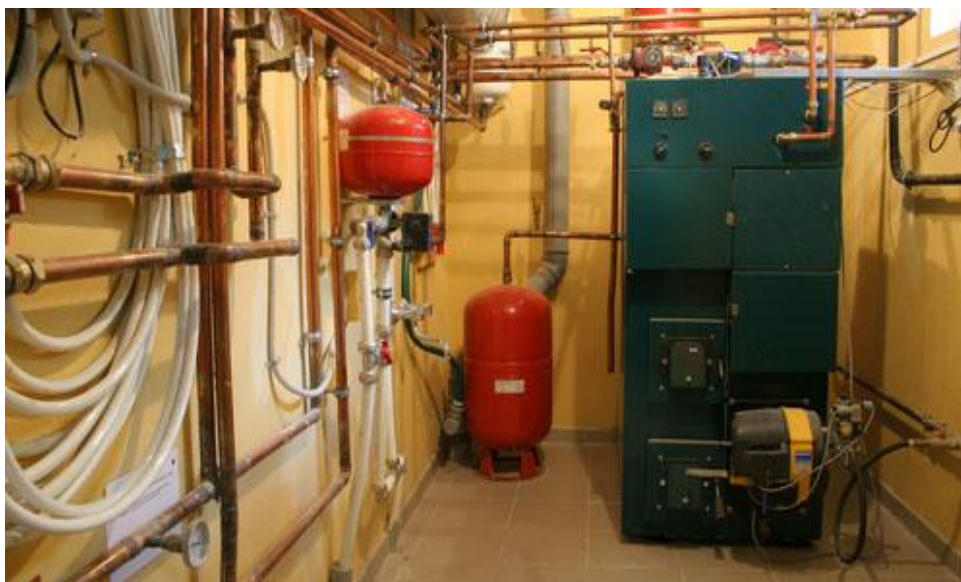
Εικόνα 6.6: Καυστήρας - λέβητας πετρελαίου.
