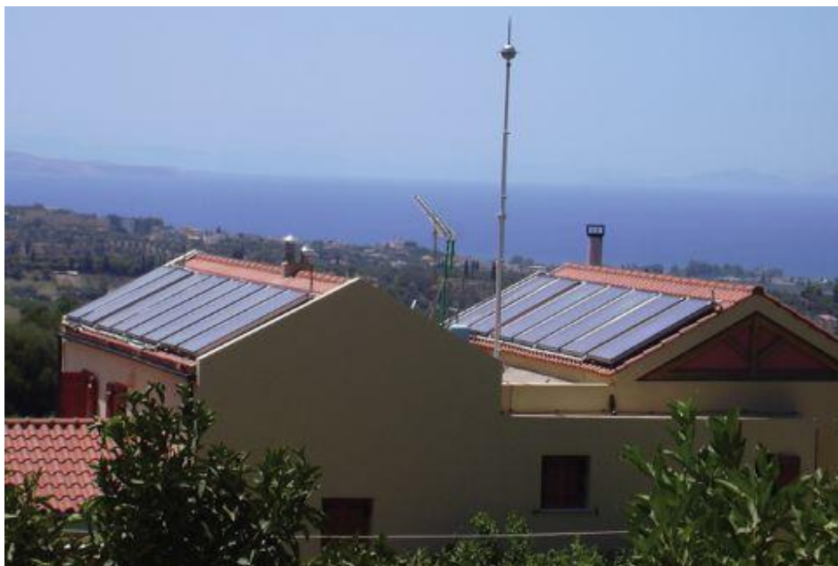
Εικόνα 6.9.: Θέρμανση κατοικίας με ηλιοθερμικό σύστημα.
