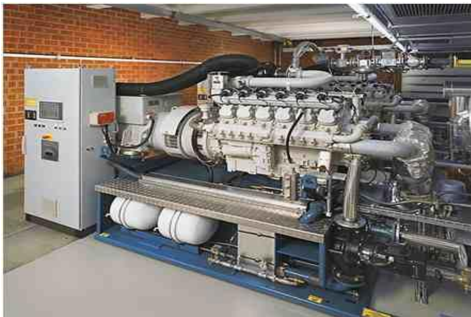
Εικόνα 7.12.: Εγκατάσταση συστήματος Σ.Η.Θ. σε βιομηχανία.
