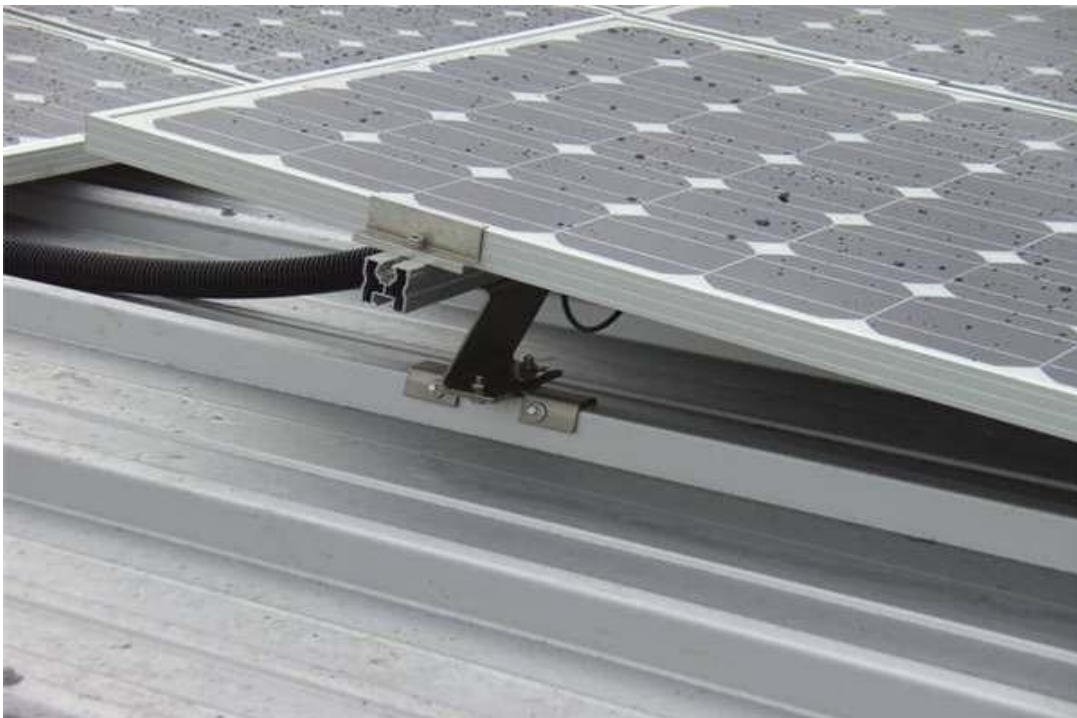
Σταθερές βάσεις σε οροφή κτιρίου
