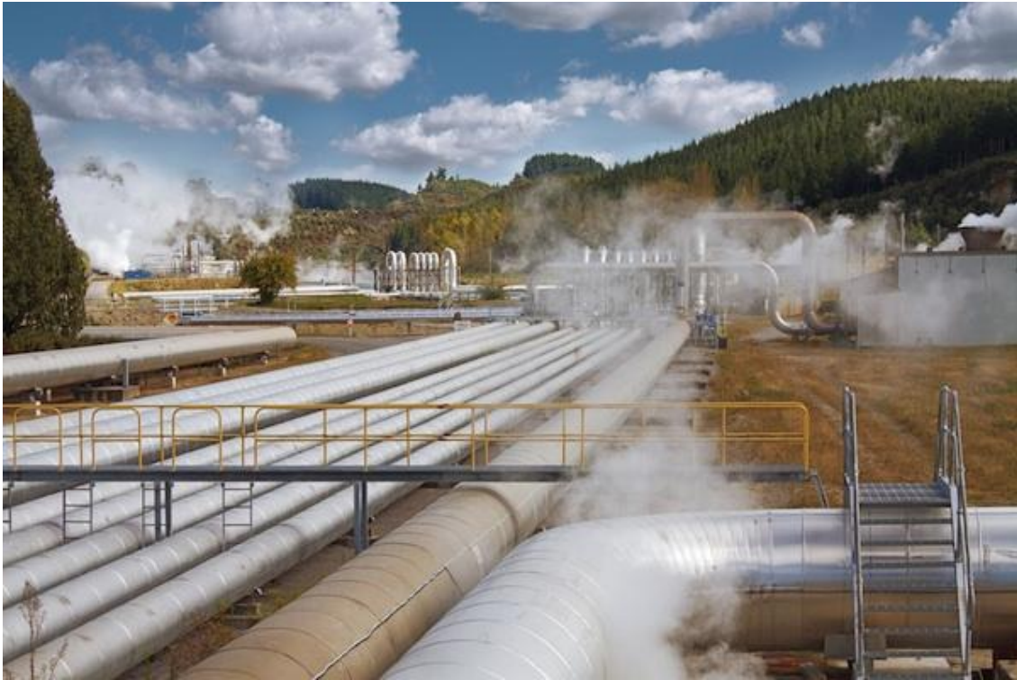
Γεωθερμική μονάδα Όρεγκον (Εικόνα 1.31)
