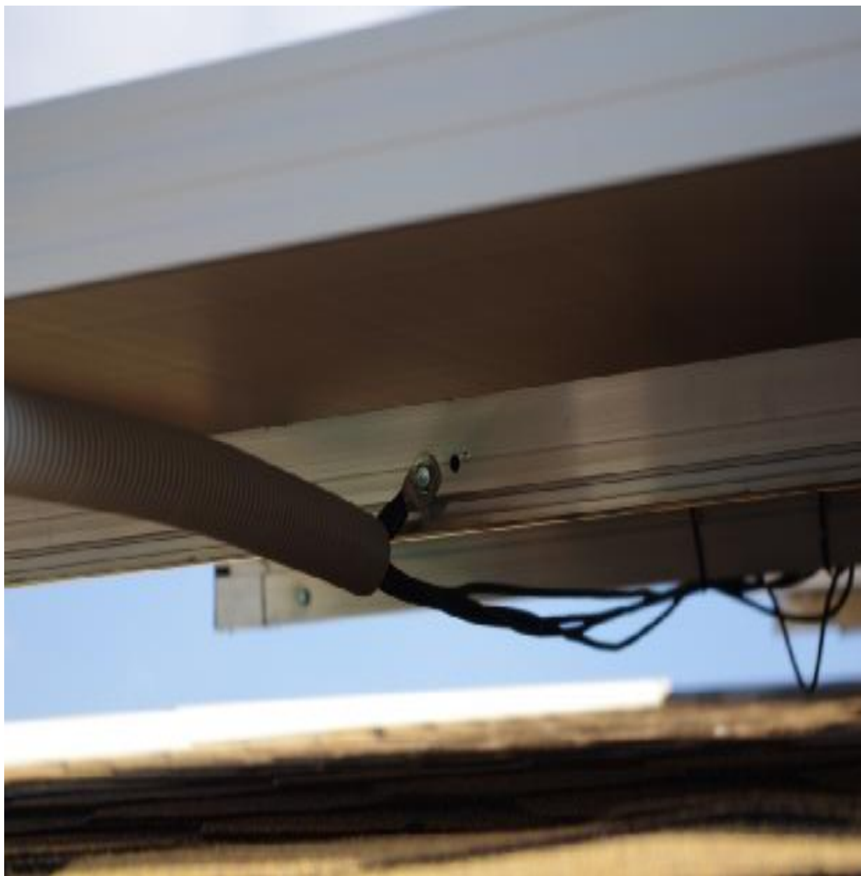
Φωτογραφία 11 : Γείωση μεταλλικών μερών εγκατάστασης
