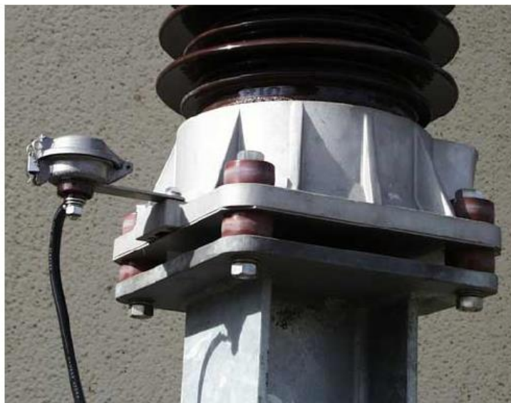
Εικόνα 30: Φλάντζα αλεξικέραυνου με σύστημα παρακολούθησης διάκενων σπινθήρων
