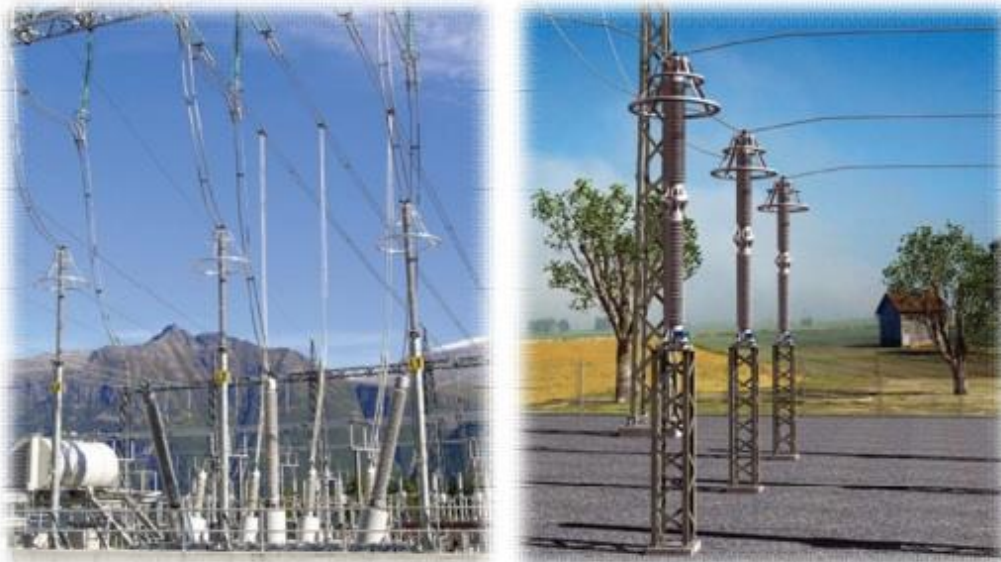
Εικόνα 17: Αλεξικέρανα 400kV και 150kV με τοροειδή
