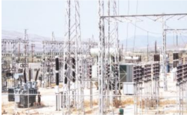
Εικόνα 30: Υποσταθμός ένωσης δικτύου υψηλής και χαμηλής τάσης [70]
