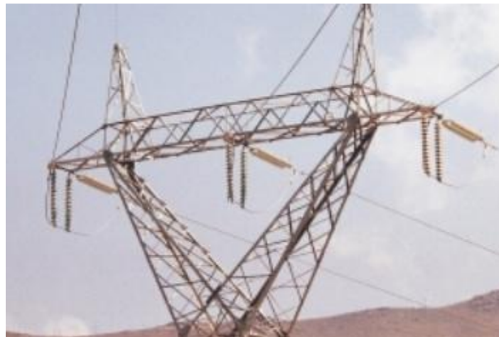
Εικόνα 31: Γραμμές μεταφοράς υψηλής τάσης [70]
