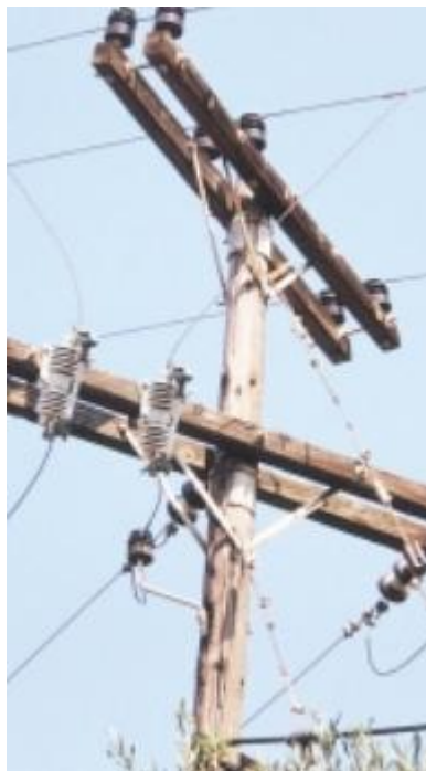
Εικόνα 29: Γραμμές μεταφοράς χαμηλής τάσης [70]
