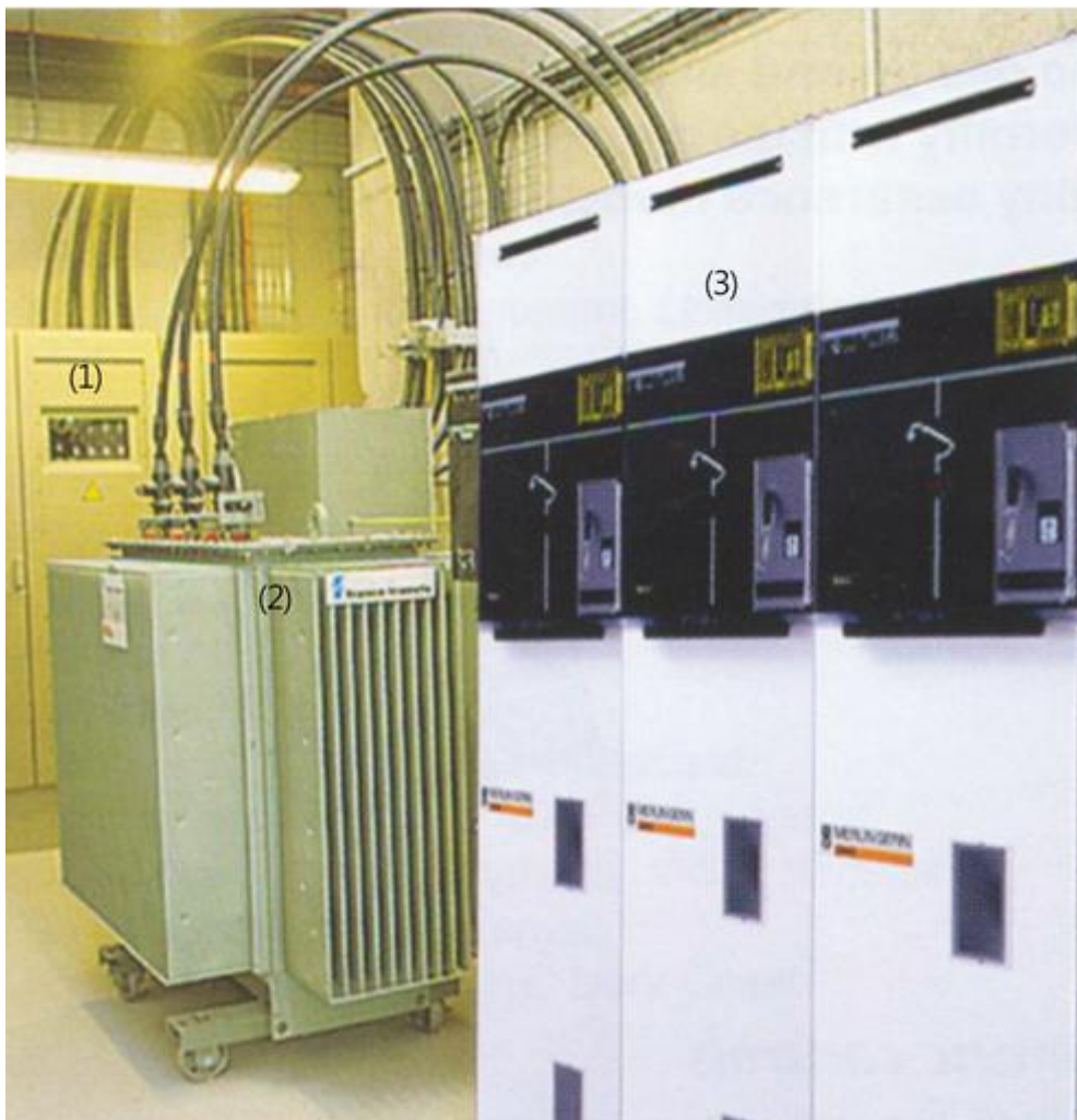
Εικόνα 32: Υποσταθμός Μέσης Τάσης: (1) Πίνακας Μέσης Τάσης (2) Μετασχηματιστής Μέσης Τάσης (3) Πίνακας Χαμηλής Τάσης [71]
