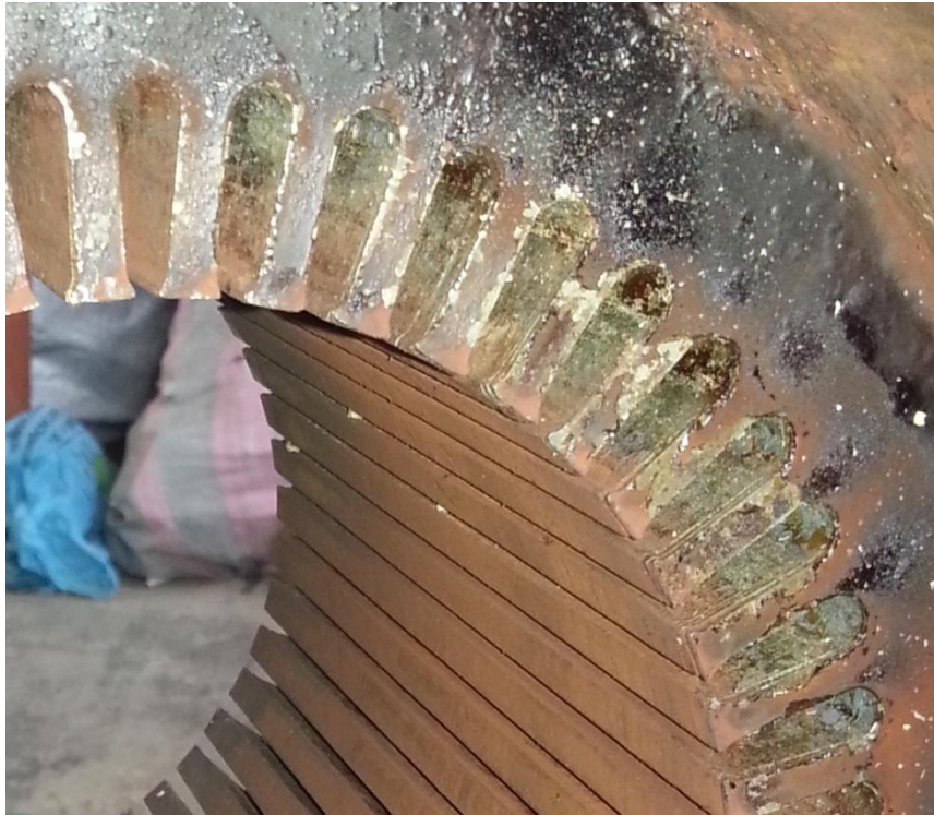
Εικόνα 12: το εσωτερικό του σάττη μόλις αφαιρέθηκε η περιέλιξη
