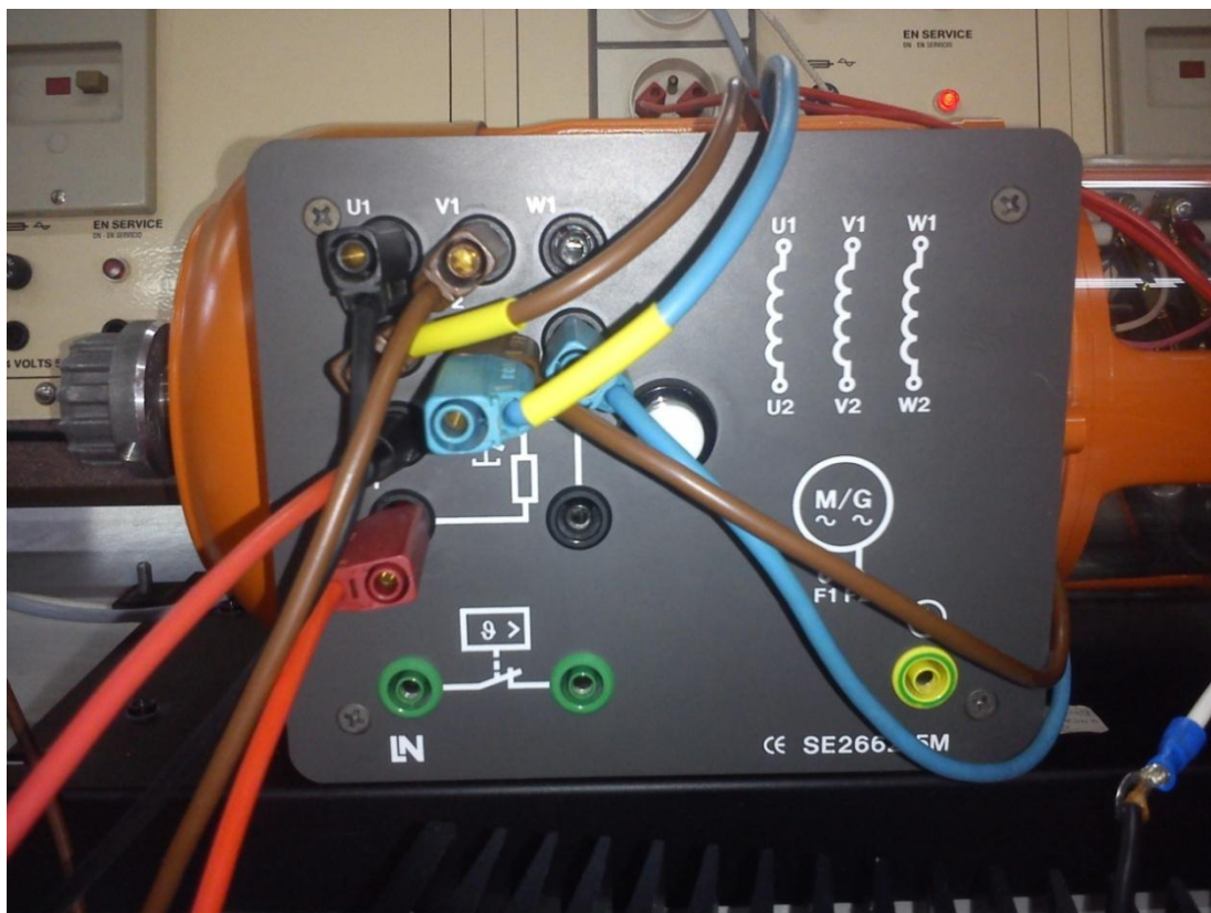
Σχήμα 4.26 Το ακροκιβώτιο της σύγχρονης γεννήτριας όπου τα τυλίγματά της είναι συνδεδεμένα σε συνδεσμολογία αστέρα. Η μηχανή στην προκειμένη περίπτωση λειτουργεί εν κενώ.
