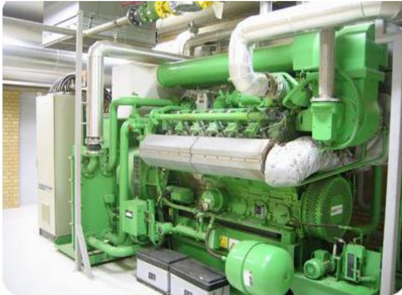
Σχήμα 4.5: Μονάδα Συμπαραγωγής Ηλεκτρικής και Θερμικής Ενέργειας
