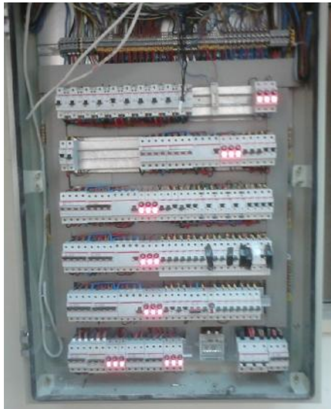
Σχήμα 9.1.2:Εσωτερική άποψη του πίνακα ισογείου
