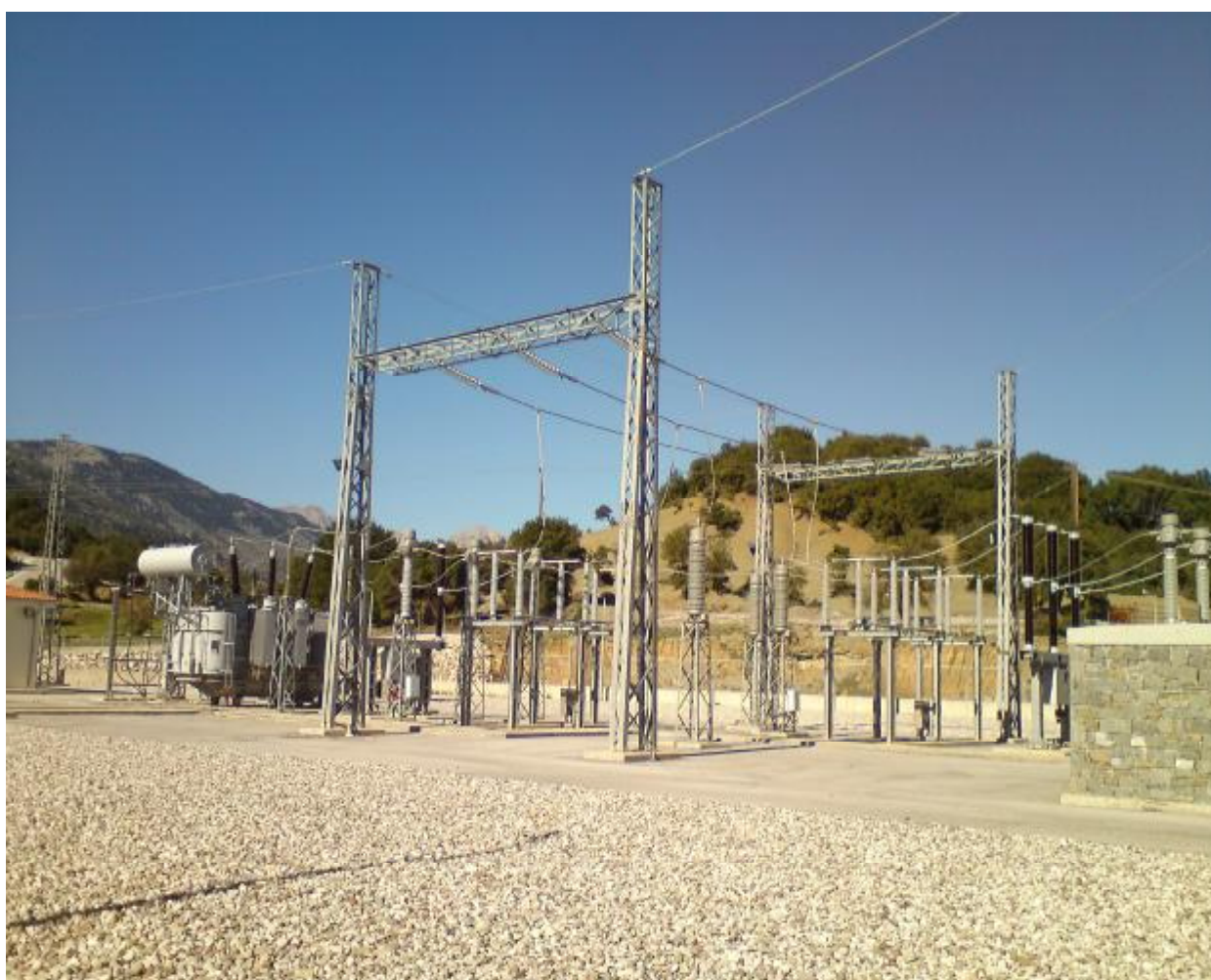
Άποψη του υποσταθμού της Δαφνοζωνάρας
