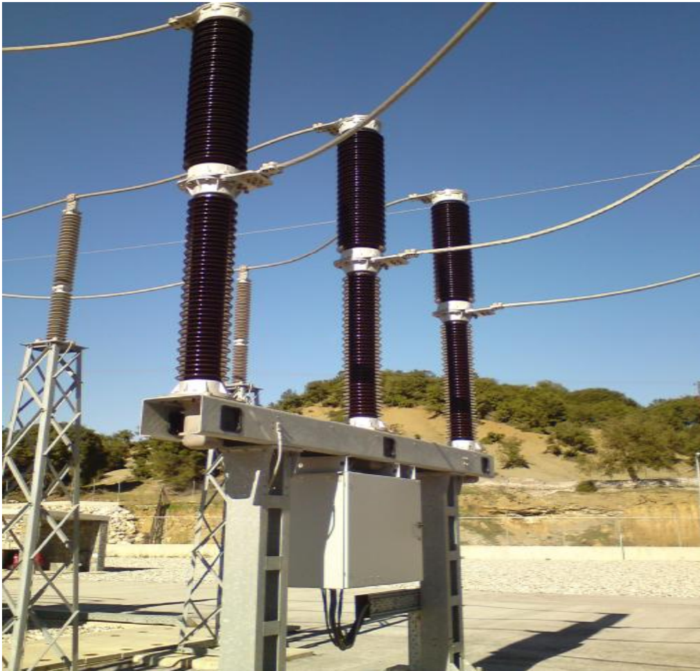
Οι διακόπτες ισχύος με εξαφθοριούχο θείο του υποσταθμού
