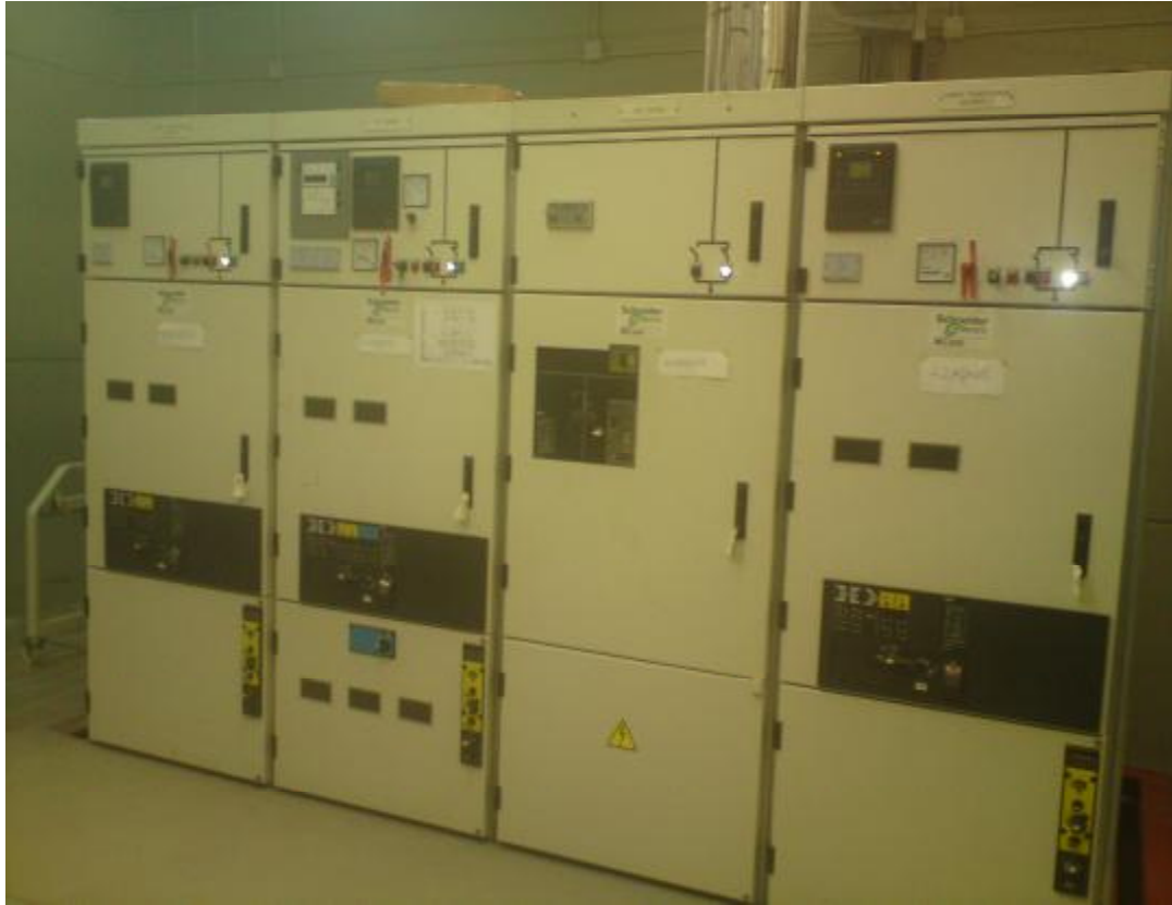
Φωτογραφία του υποσταθμού
