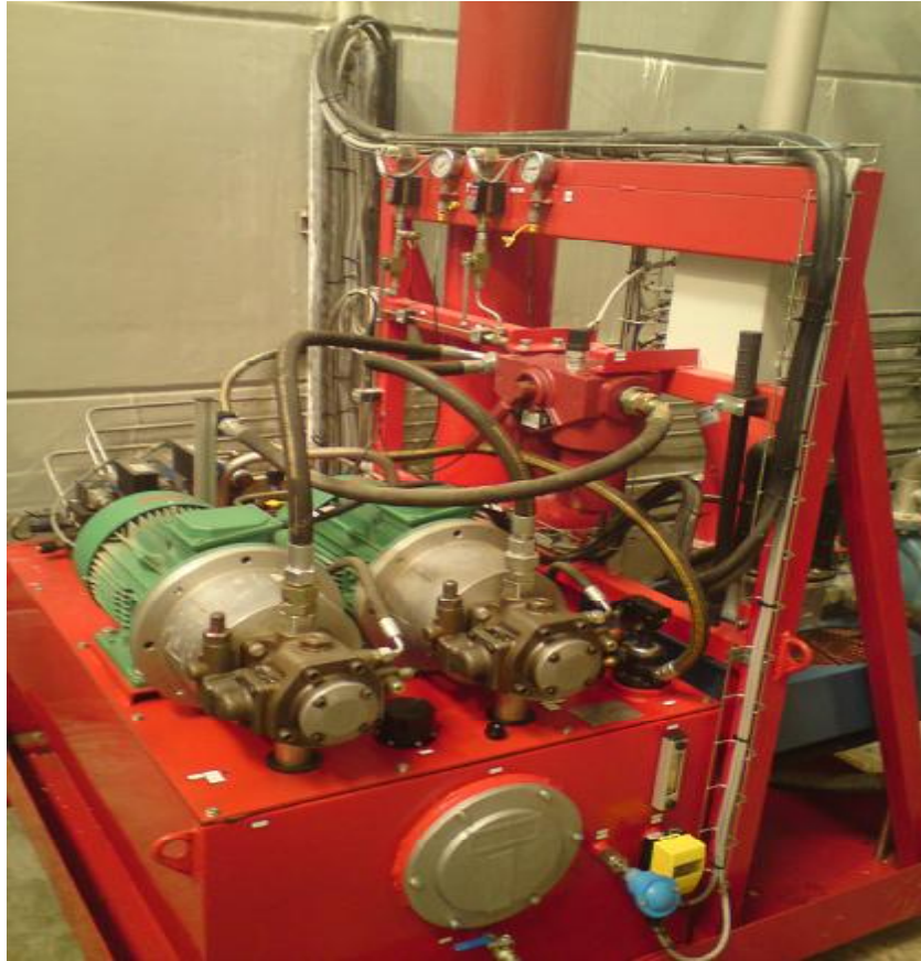
Η υδραυλική μονάδα που ελέγχει την θέση των περυγίων του υδροστροβίλου
