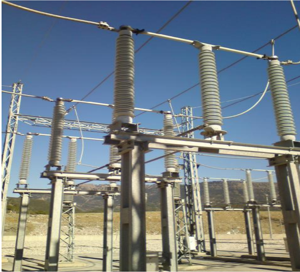
Οι αποζεύκτες του υποσταθμού
