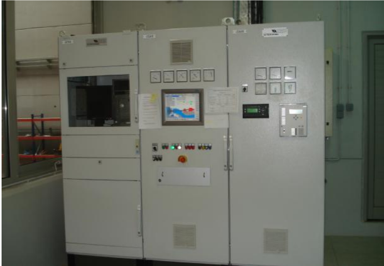
Οι κεντρικοί πίνακες του Room Control
