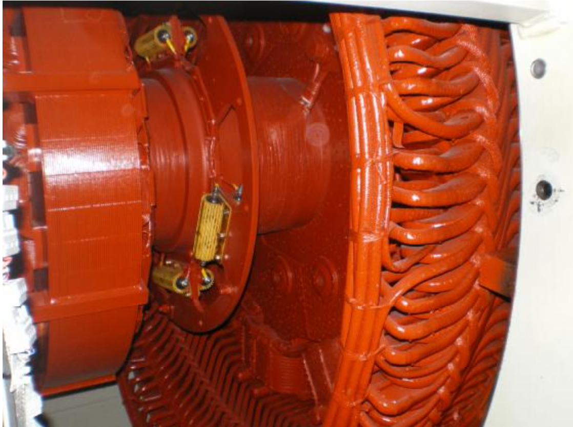
Τμήμα των τυλιγμάτων της γεννήτριας
