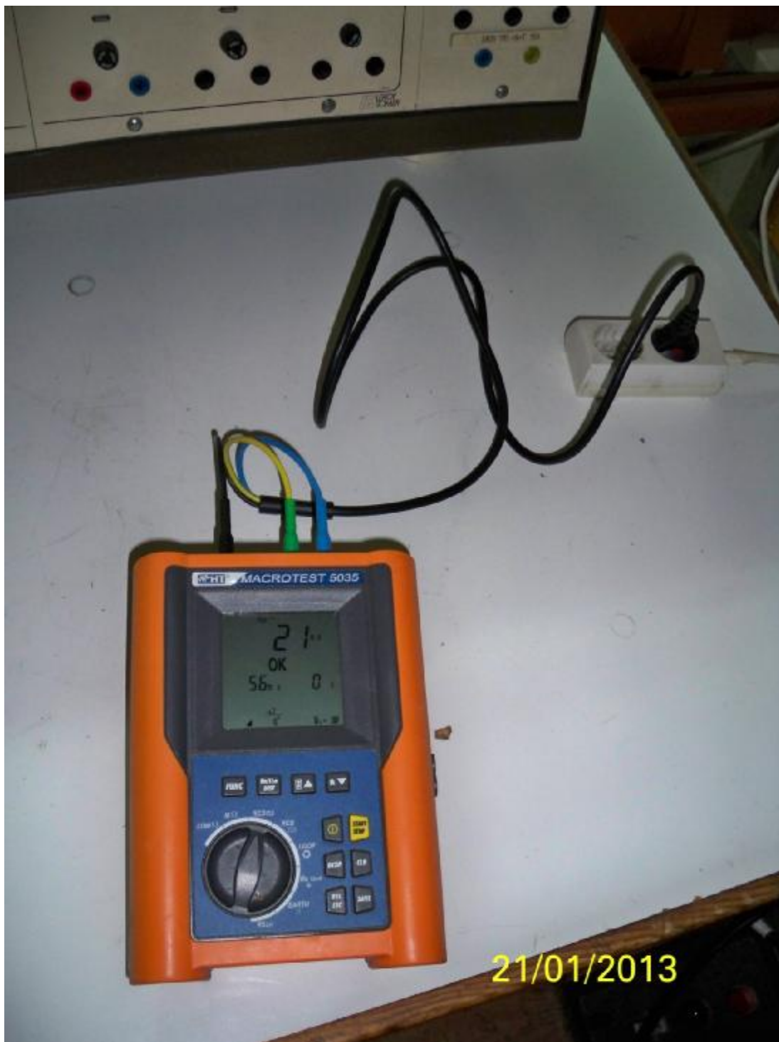
Εικόνα 6.4 Έλεγχος RAMP σε RCD
