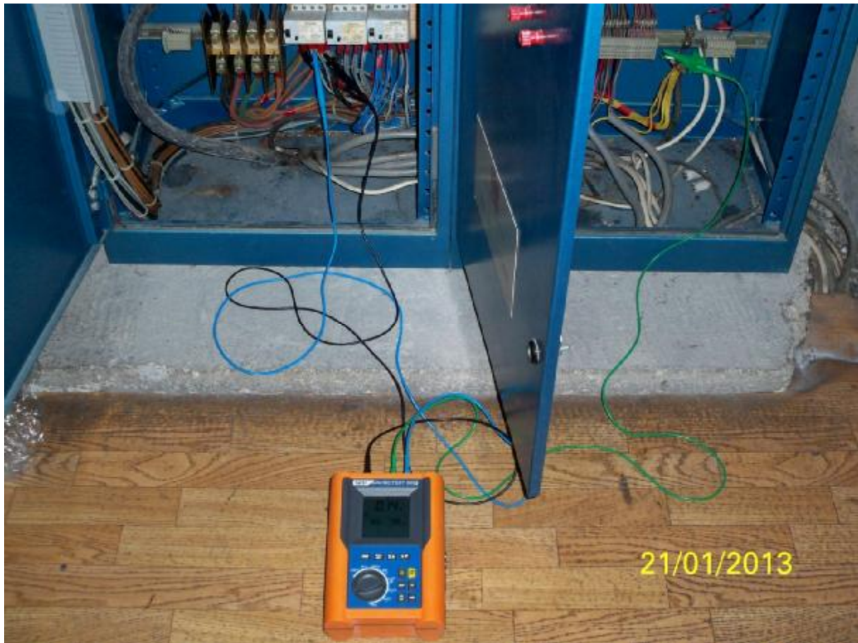
Εικόνα 6.8 μέτρηση σύνθετης αντίστασης βρόχου σφάλματος και ρεύματος βραχυκυκλώματος για P-P
