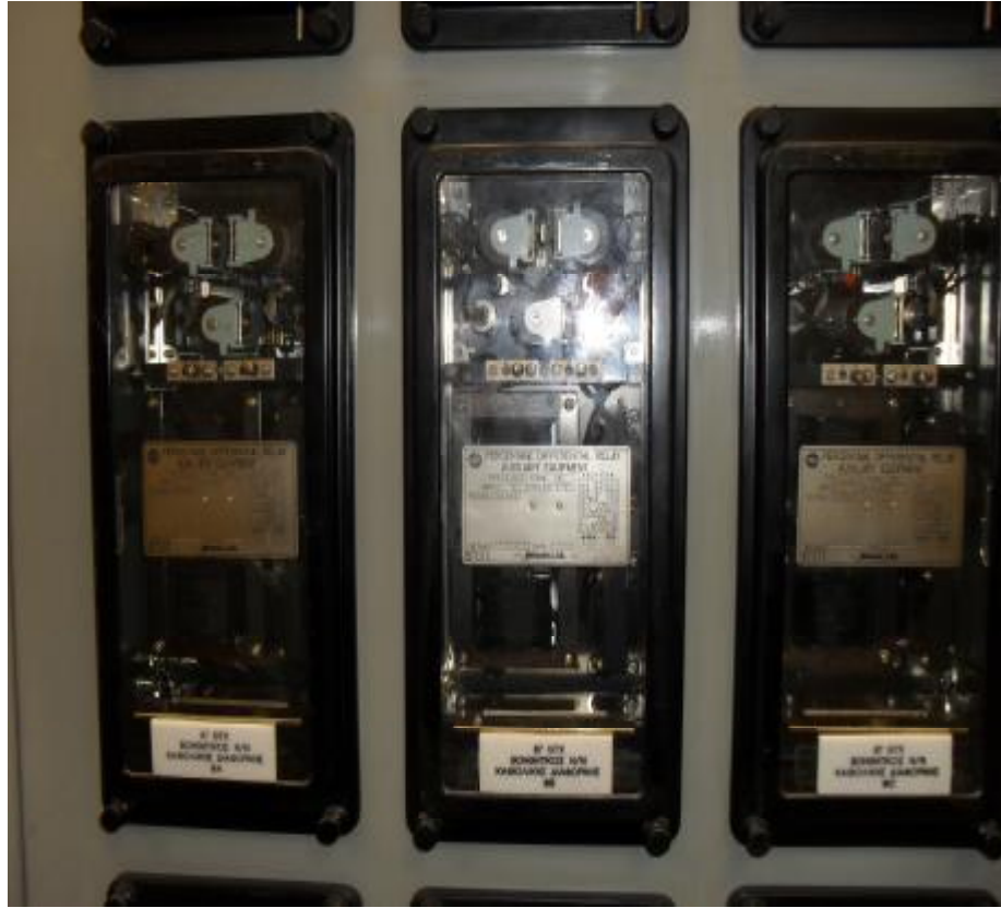
(ΗΛΕΚΤΡΟΝΟΜΟΙ -ΒΡΙΣΚΟΝΤΑΙ ΟΠΙΣΘΕΝ ΠΙΝΑΚΑ ΕΛΕΓΧΟΥ)
