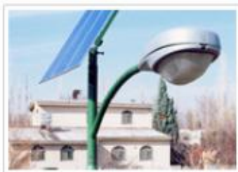
Αυτόνομο φωτιστικό οδού
