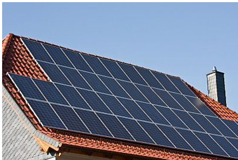
Εικ.3 Φωτοβολταϊκά σε στέγη
