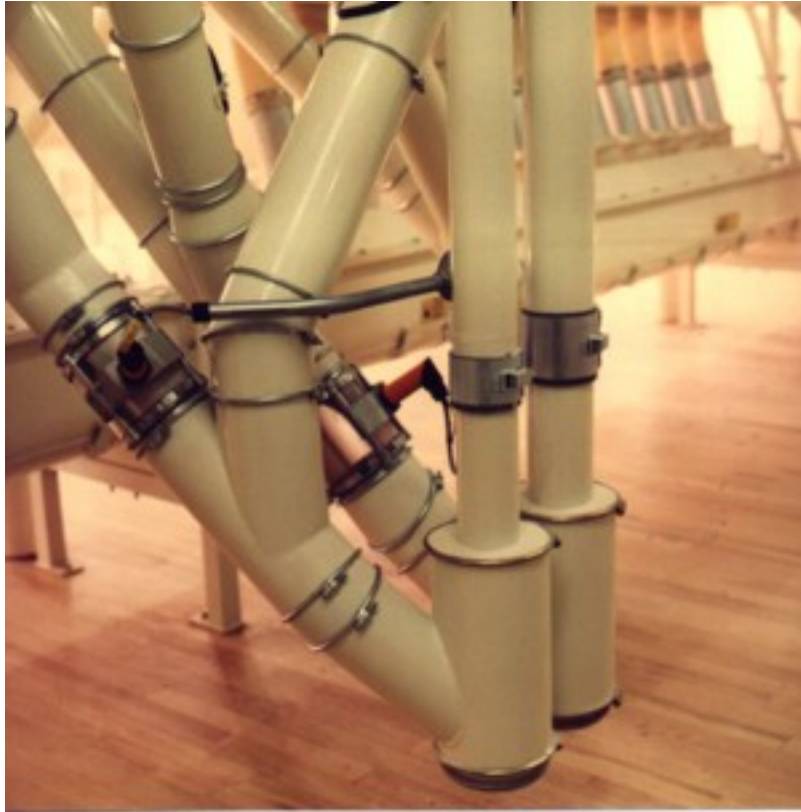
Εικόνα 3.24 : Έλεγχος σημείου στάθμης με αισθητήρα τύπου ΚΙ σε ένα αλευρόμυλο
