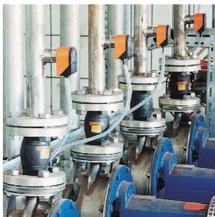
Εικόνα 3.17 : Ηλεκτρονικοί Επιτηρητές Ροής
