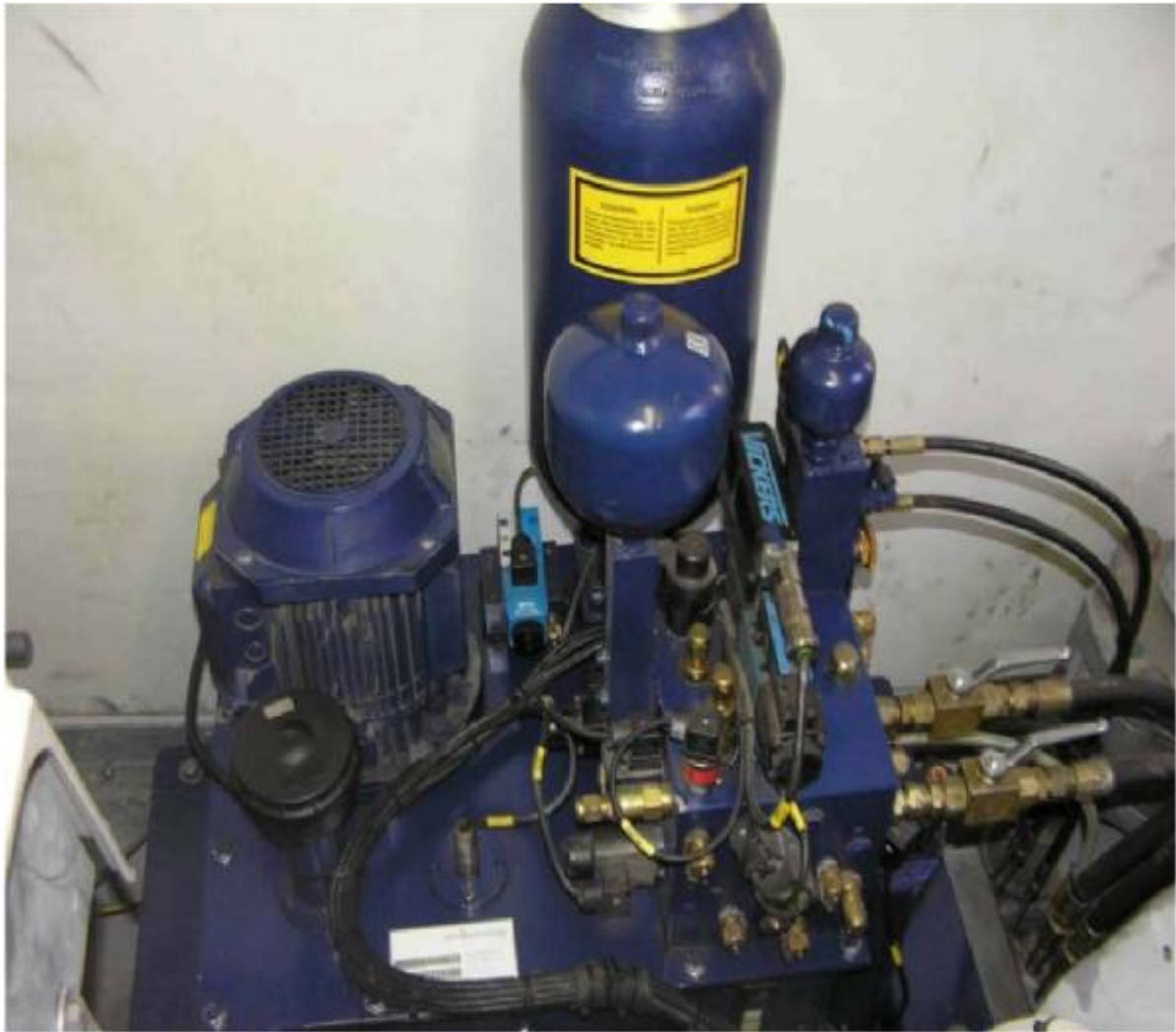
Σχήμα 2.15 Φωτογραφίες της αντλίας λαδιού τοποθετημένη στην ανεμογεννήτρια
