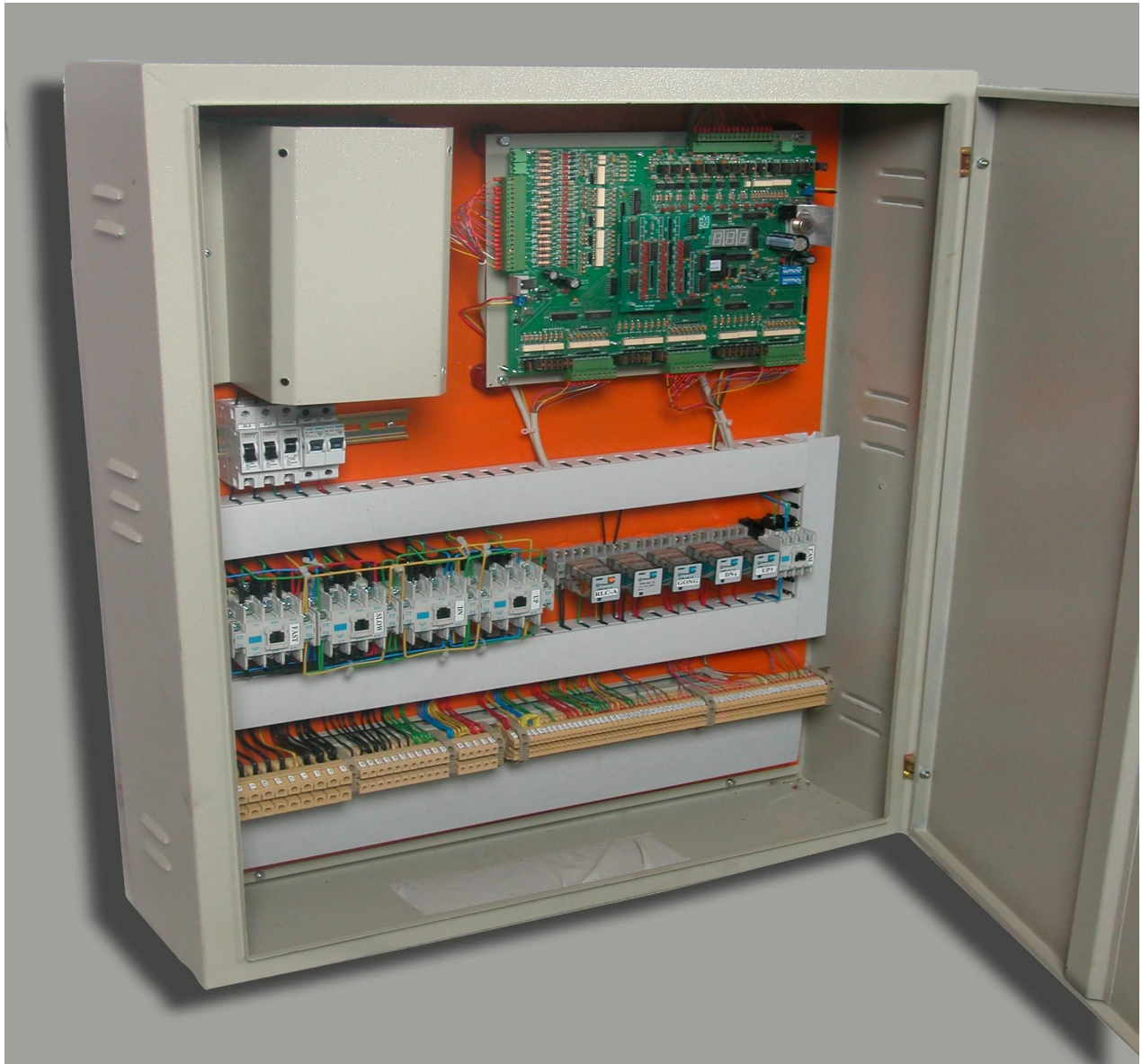
εικόνα 36: πίνακας με PLC
