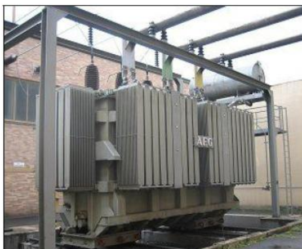
Μ/Σ μονάδας σε σταθμό παραγωγής
