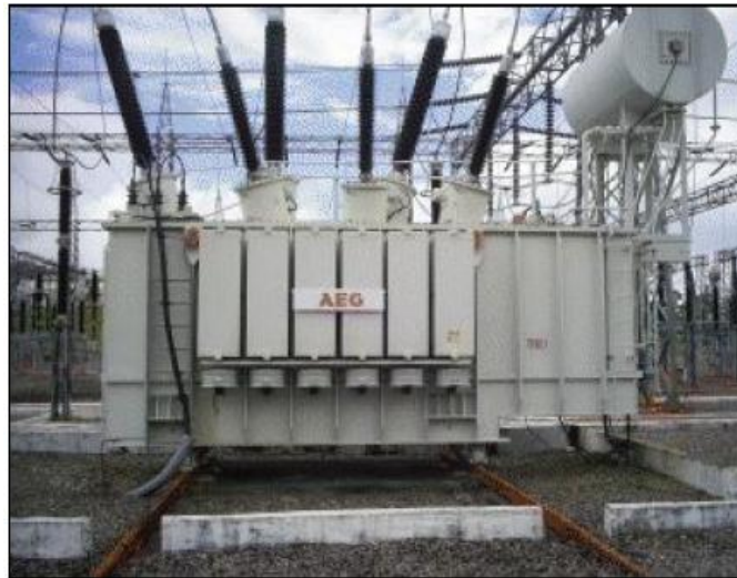
Μ/Σ υποσταθμού 250 MVA
