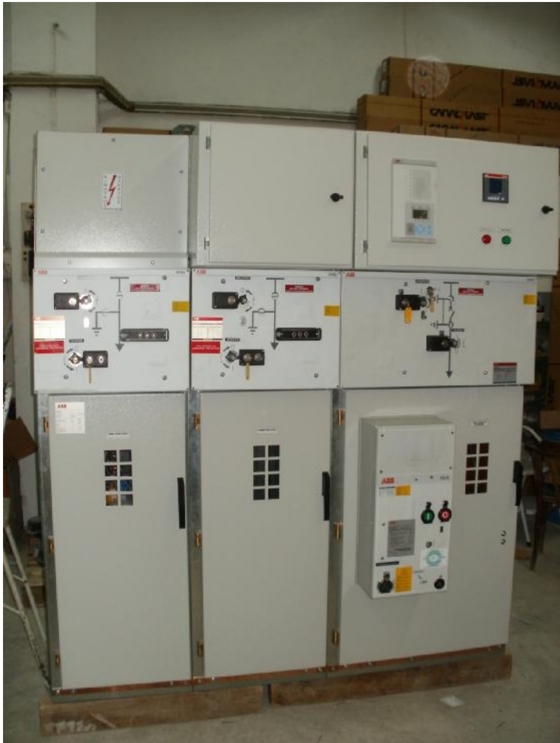
Τυπικές κυψέλες Μ.Τ με εμφανείς τους ΔΙ και τους ΔΦ SF6 κατά τη διάρκεια της κατασκευής.
