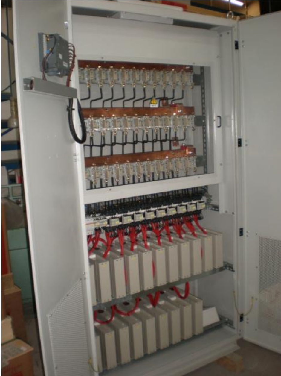
Πεδίο πυκνωτών αντιστάθμισης άεργου ισχύος
