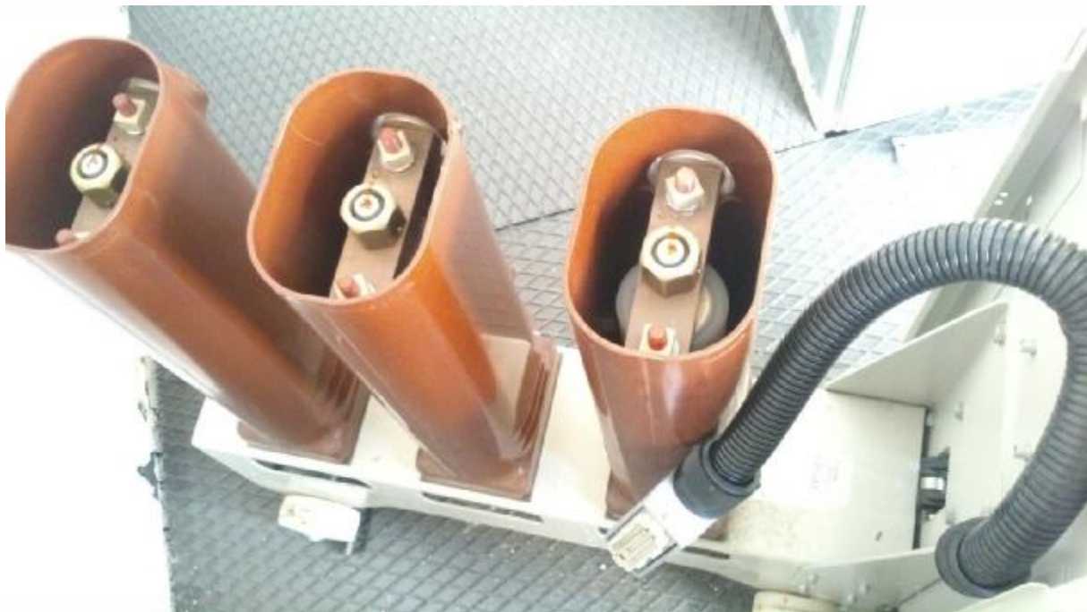
Διακόπτης Ισχύος SF6 την στιγμή της τοποθέτησης σε πεδίο μέσης τάσης για την ηλεκτροδότηση καταναλωτή
