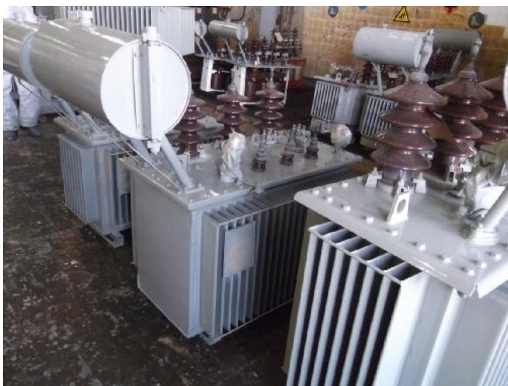
Σχήμα 7.5.3 Ελαιόφυκτοι Μ/Σ 20/0.4 kV
