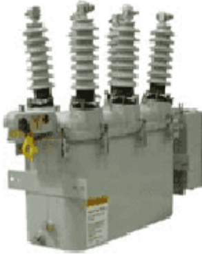
Διακόπτης Απομόνωσης με δοχείο Λαδιού
