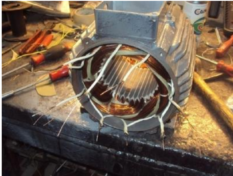
Εικόνα 9 : Ολοκλήρωση της τοποθέτησης των τυλιγμάτων στο στάτη. Σε αυτήν την εικόνα φαίνονται και οι γεφυρωμένοι ακροδέκτες.
