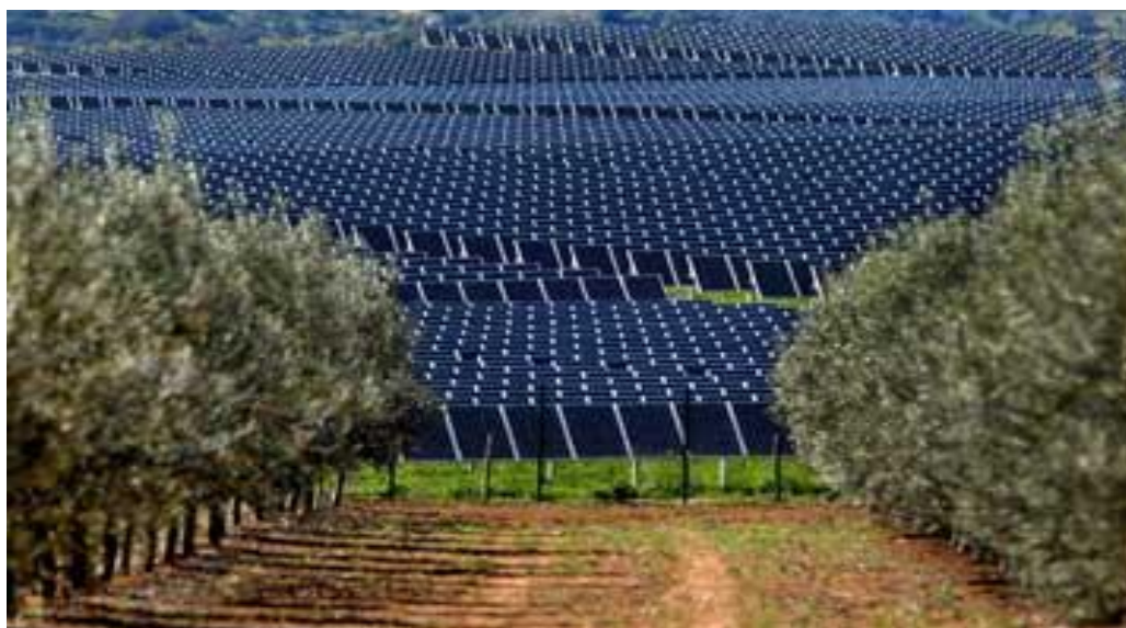
Εικόνα 1.7: Η μεγαλύτερη φωτοβολταϊκή εγκατάσταση παγκοσμίως ξεκίνησε να κατασκευάζεται στη Πορτογαλία. Το ηλιακό πάρκο λειτουργεί προσφέροντας ισχύ 11 Megawatt αρκετή για να καλύψει της ανάγκες 8000 σπιτιών
