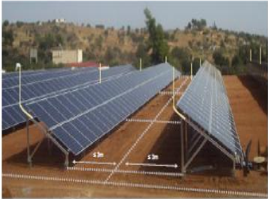
Εικόνα 4.23: Διάταξη ηλεκτροδίου γείωσης τύπου Β για μη απομονωμένο ΣΑΠ. Οι ακίδες σύλληψης για δύο συνεχόμενες φωτοβολταϊκές συστοιχίες συνδέονται με ένα ηλεκτρόδιο που είναι εγκαταστημένο ανάμεσα τους.
