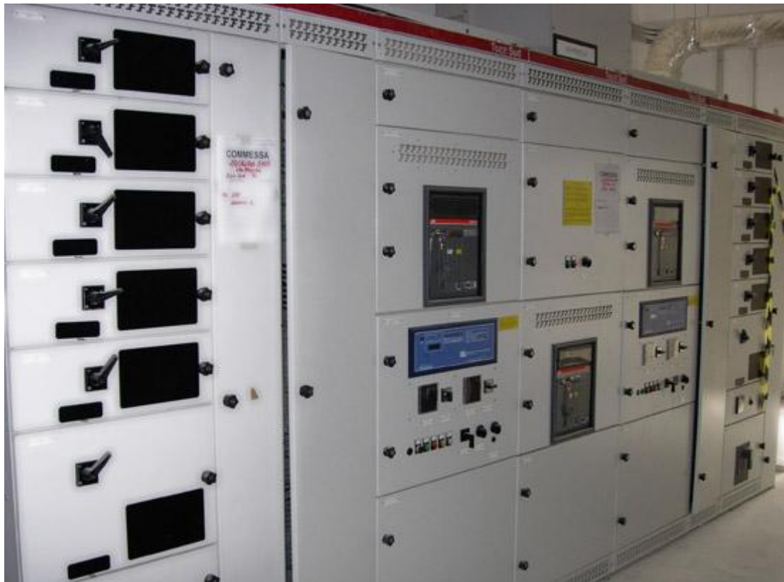
Σχήμα 1.7 Πίνακες αίθουσας χειρισμών υποσταθμού
