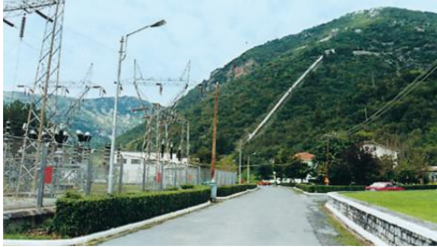
Σχήμα 1.2: Το υδροηλεκτρικό εργοστάσιο του Λάδωνα, στην Αρκαδία.
