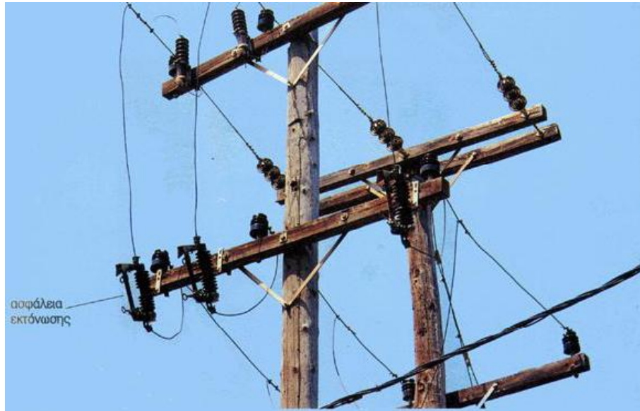
Σχήμα 1.4: Ασφάλεια εκτόνωσης σε δίκτυο 20 kV της ΔΕΗ.
