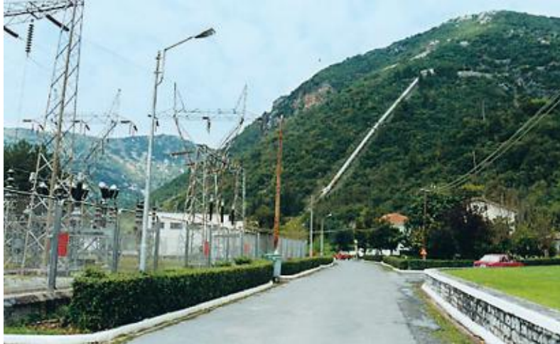
Σχήμα 1.3.1: Το υδροηλεκτρικό εργοστάσιο του Λάδωνα, στην Αρκαδία.
