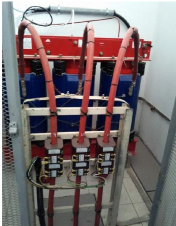
Εικόνα 5.4.18 Μ/Σ υποβιβασμού 20/0,4 kV
