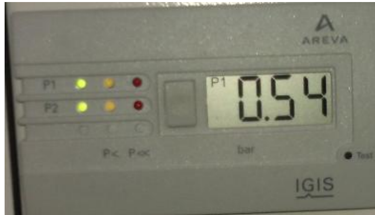
Εικόνα 5.4.17 Όργανο μέτρησης πίεσης αερίου.
