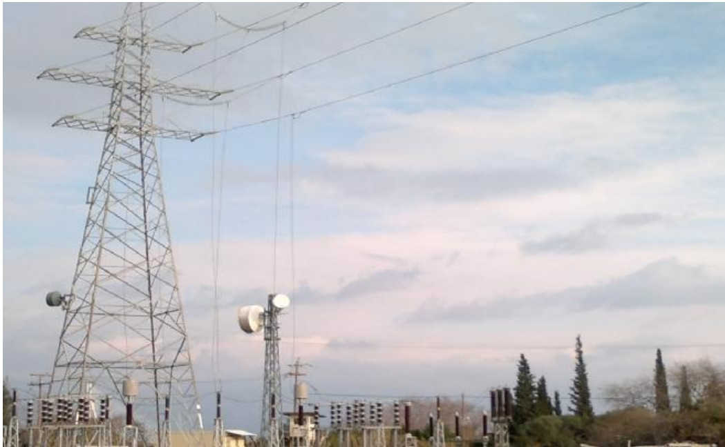
Εικόνα 5.4.21 Πυλώνας Υ.Τ στον Υ/Σ της ΔΕΗ στο Ρίο.
