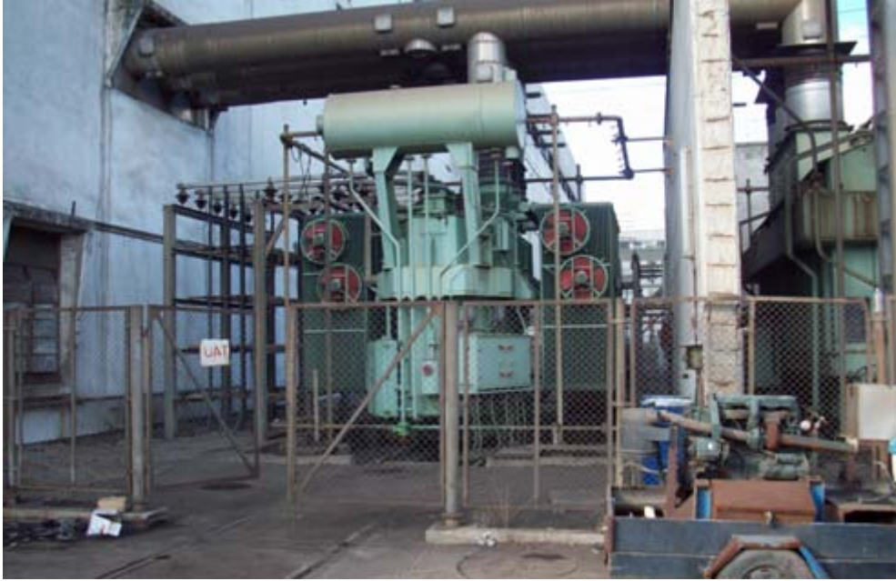
Σχήμα 17. Μ\Σ 3 ης μονάδας ΑΗΣ Μεγαλόπολης (20KV-6KV).
