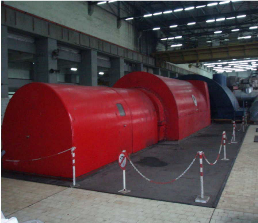
Σχήμα 5. Γεννήτρια 3 ης μονάδας.
