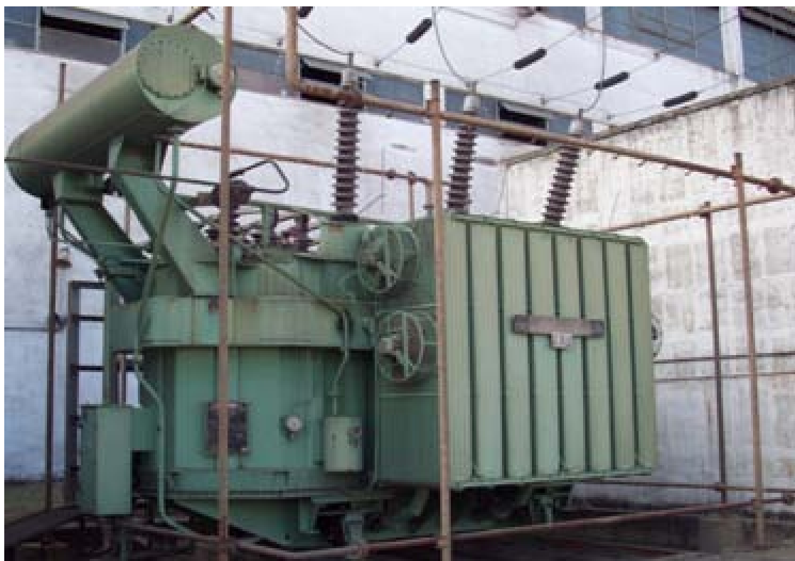
Σχήμα 16. Άποψη μετασχηματιστή μονάδος.
