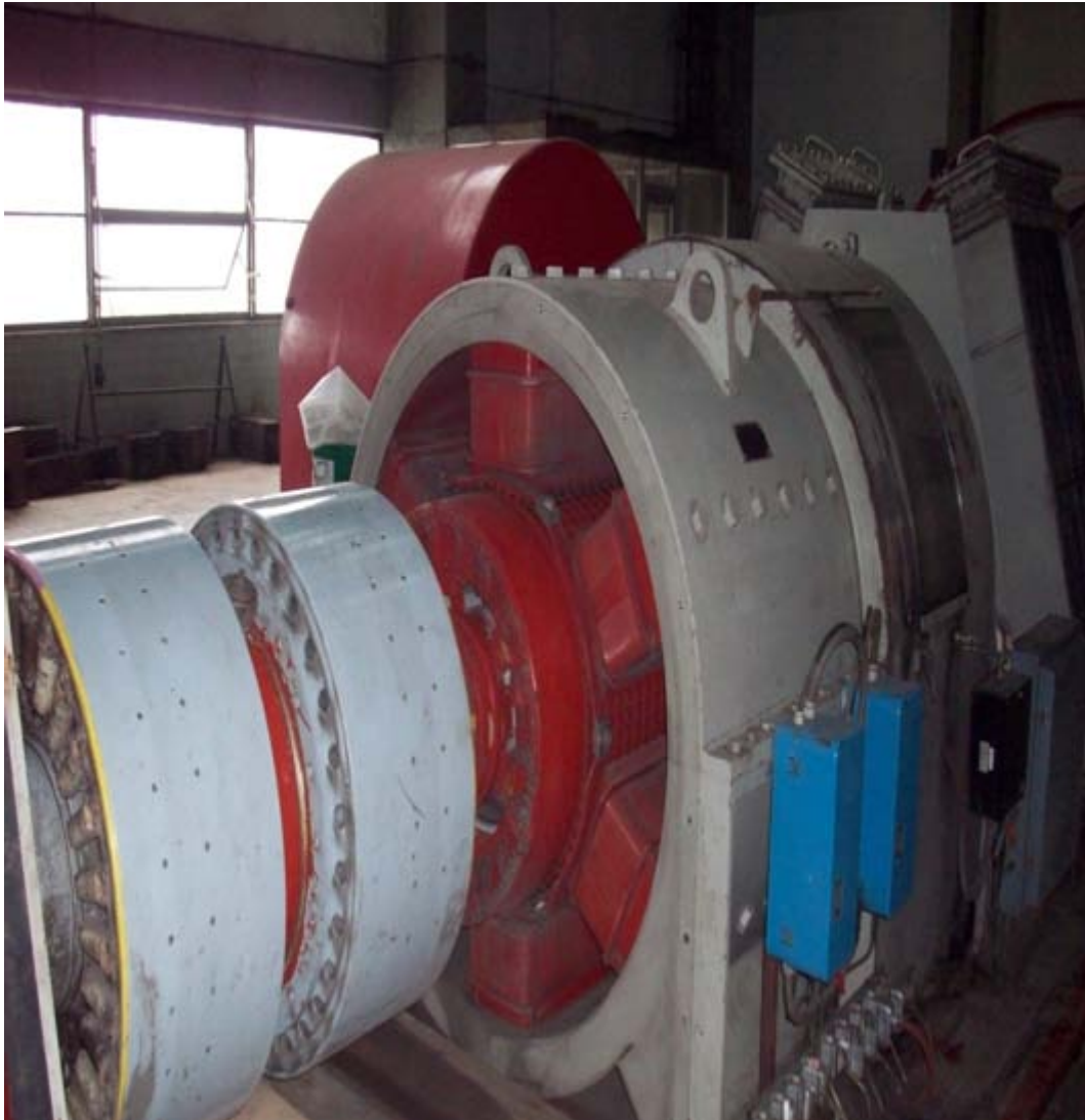
Σχήμα 27. Αποψη διέγερσης μονάδος.
