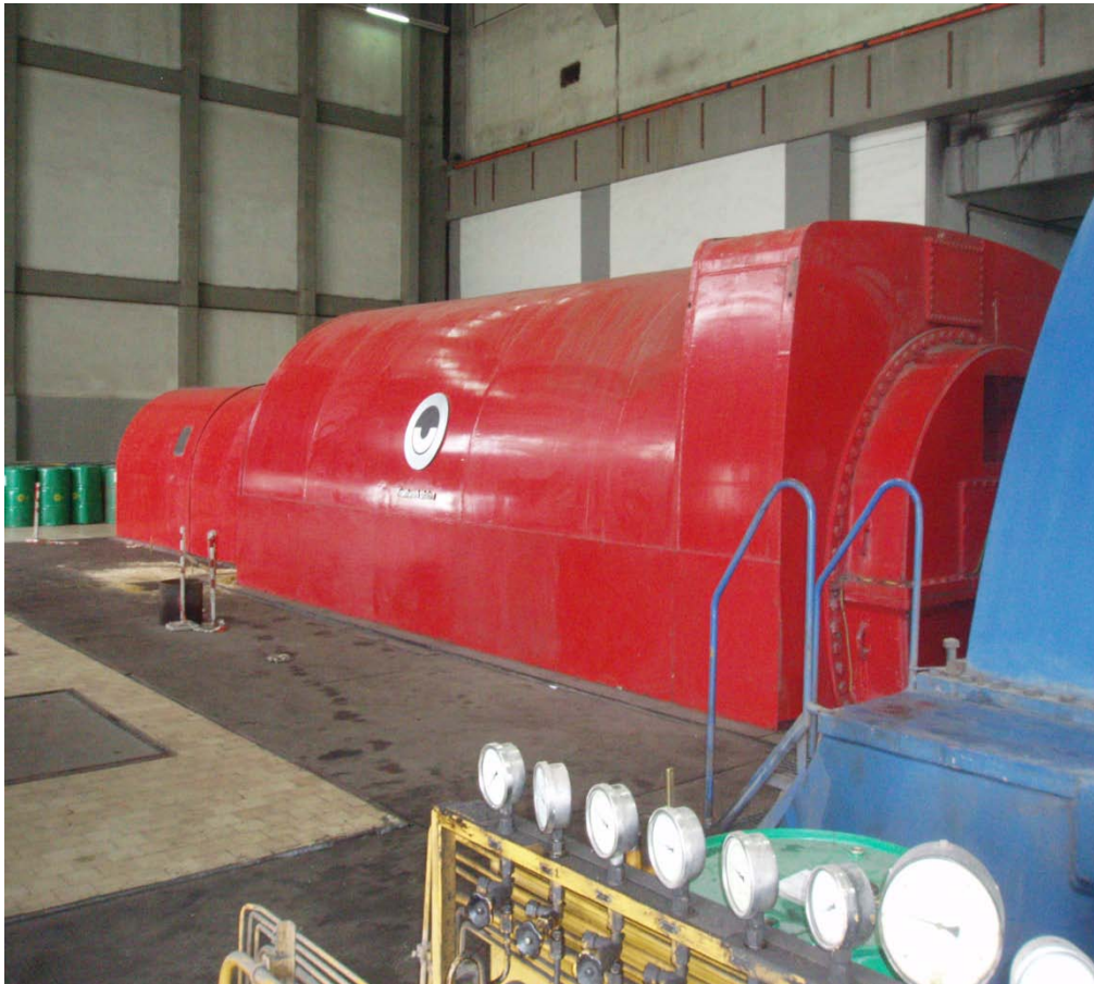
Σχήμα 7. Άποψη εξωτερικού κυλίνδρου γεννήτριας.
