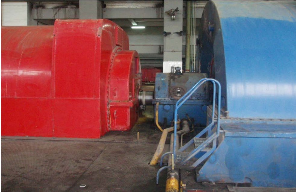
Σχήμα 6. Αποψη γεννήτριας μονάδος.
