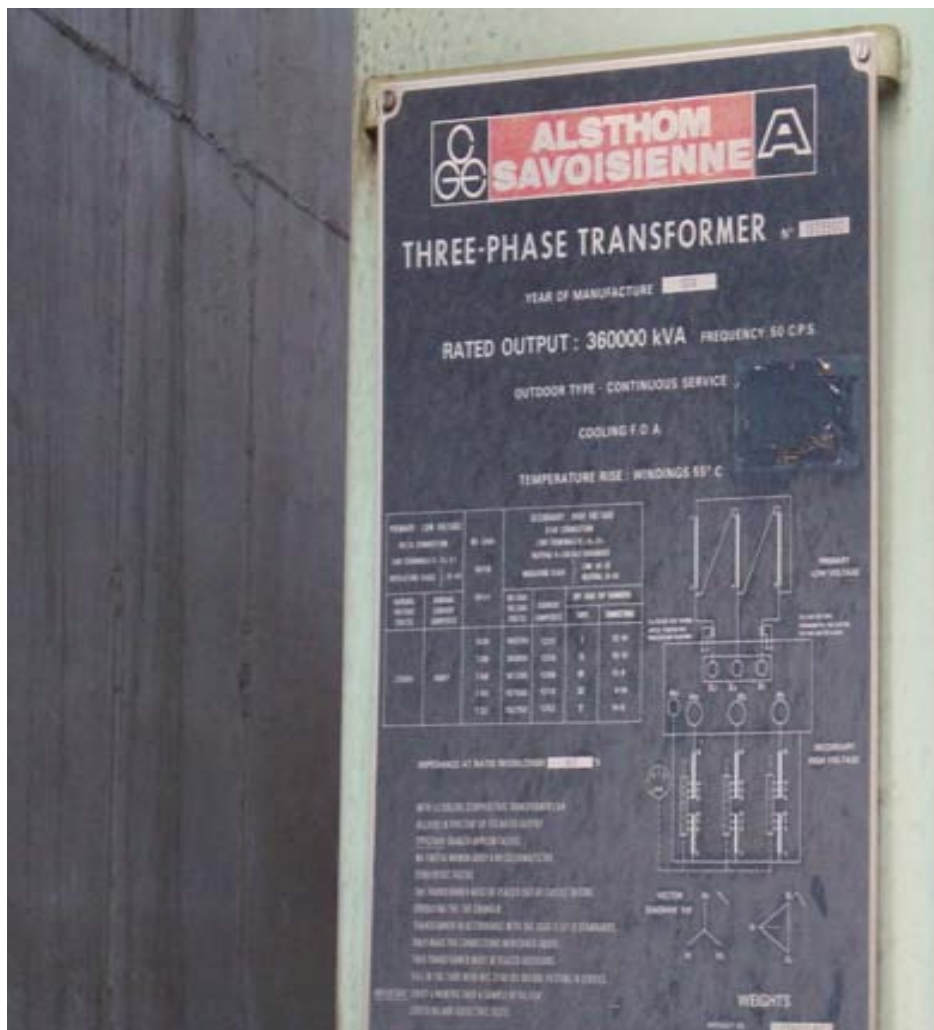
Σχήμα 15. Ηλεκτρικά χαρακτηριστικά μετασχηματιστή.
