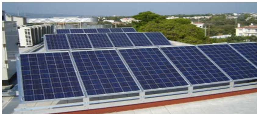
Εικόνα 37: Φωτοβολταϊκά πλαίσια σε κτίριο σε κεκλιμένο επίπεδο
