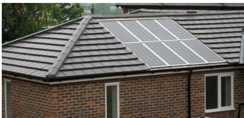
Εικόνα 39: Φωτοβολταϊκό πλαίσιο με απευθείας τοποθέτηση
