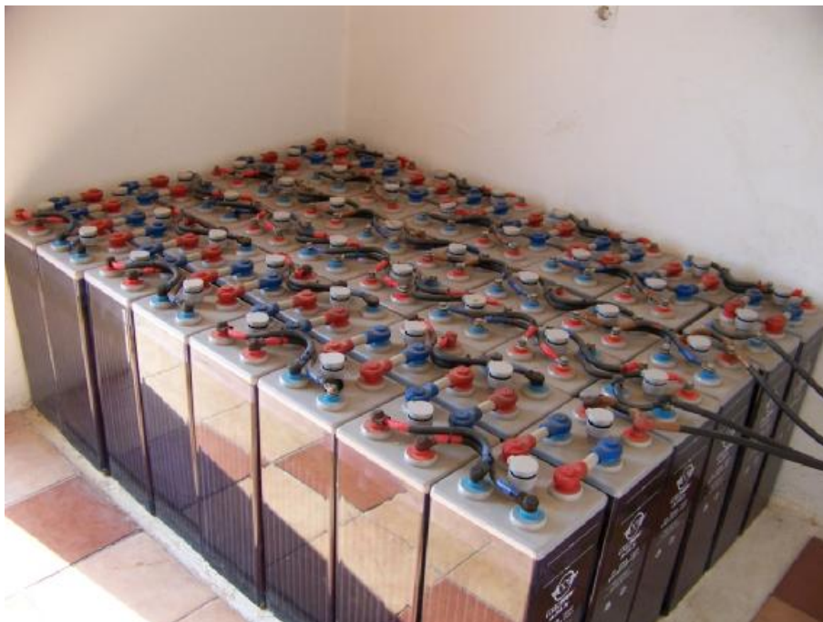
Σχήμα 6.8: Οι 48 συσσωρευτές της εγκατάστασης. Διακρίνονται οι 4 αγωγοί (δύο παράλληλοι κλάδοι, 24 συσσωρευτές έκαστος) που τους συνδέουν με τις διατάξεις φόρτισης.
