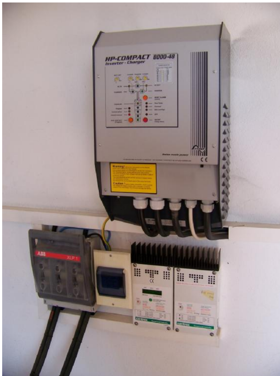
Σχήμα 6.10: Ο Αντιστροφείας και οι φορτιστές των συσσωρευτών. Επίσης στο αριστερό μέρος της φωτογραφίας διακρίνονται οι 4 αγωγοί (2 ζεύγη) που καταλήγουν στους συσσωρευτές.
