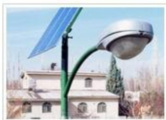
Αυτόνομο φωτιστικό οδού
