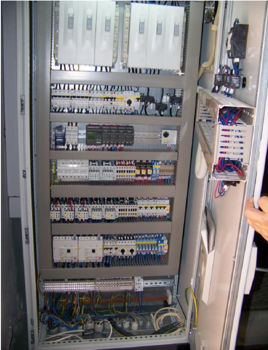
Σχήμα 6.13: Φωτογραφία του πίνακα αυτοματισμού για το χειρισμό όλης της εγκατάστασης. Το σύστημα επιτηρεί την παραγόμενη ενέργεια, το επίπεδο φόρτισης των συσσωρευτών και τη ζήτηση ισχύος από τις καταναλώσεις και αν χρειαστεί εκκινεί το H/Z για να καλύψει τη ζήτηση.
