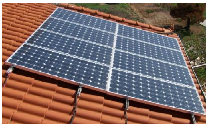
Σχήμα 6.5: Λεπτομέρεια της δεύτερης συστοιχίας φωτοβολταϊκών. Στο πάνω δεξιά άκρο της φωτογραφίας διακρίνεται ο αγωγός μεταφοράς της παραγόμενης ηλεκτρικής ενέργειας.
