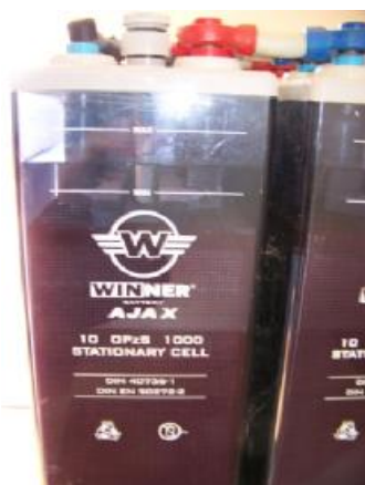
Σχήμα 6.9: Λεπτομέρεια τους ενός συσσωρευτή. Διακρίνονται τα χαρακτηριστικά του, καθώς η στάθμη του ηλεκτρολύτη.
