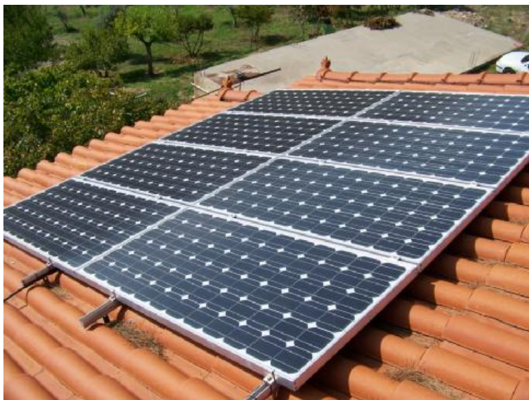
Σχήμα 6.4: Λεπτομέρεια της στήριξης της μιας εκ των δύο συστοιχιών στη σκεπή του οικήματος. Είναι φανερό αποτελείται από 8φωτοβολταϊκά πλαίσια
