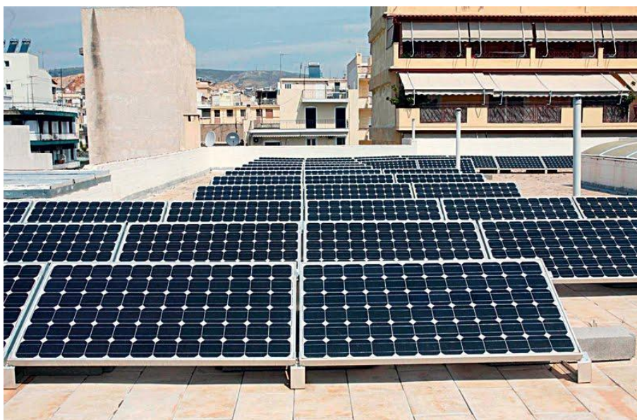
4.12 Φωτογραφία φωτοβολταϊκών πλαισίων σε κτίριο με επίπεδη οροφή
