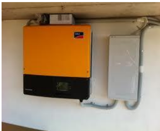
4.13 Μετατροπέας συνδεδεμένος στο δίκτυο.
